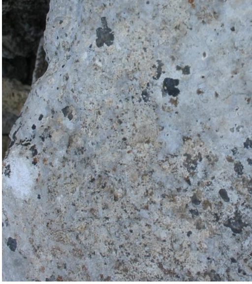
Resim 4.17. P12 mezar yapısı taşları yüzeyindeki algler
