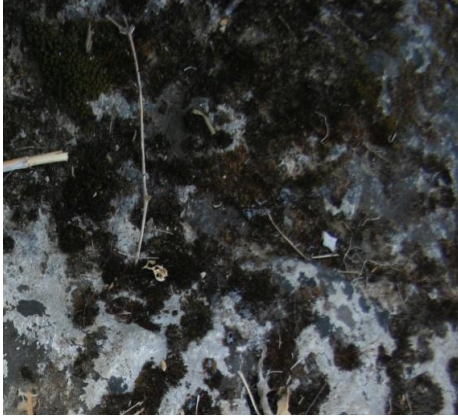
Resim 4.14. P12 kodlu mezar yapısı yosun görünümü detay
