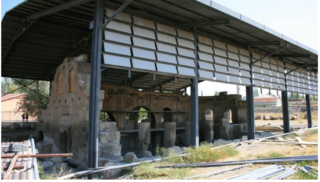
Resim 5.3. Eski Andaval Konstantin ve Helena Kilisesi koruyucu çatı örtüsü çalışmaları (Fazıl Açıkgöz Resim Arşivi)
