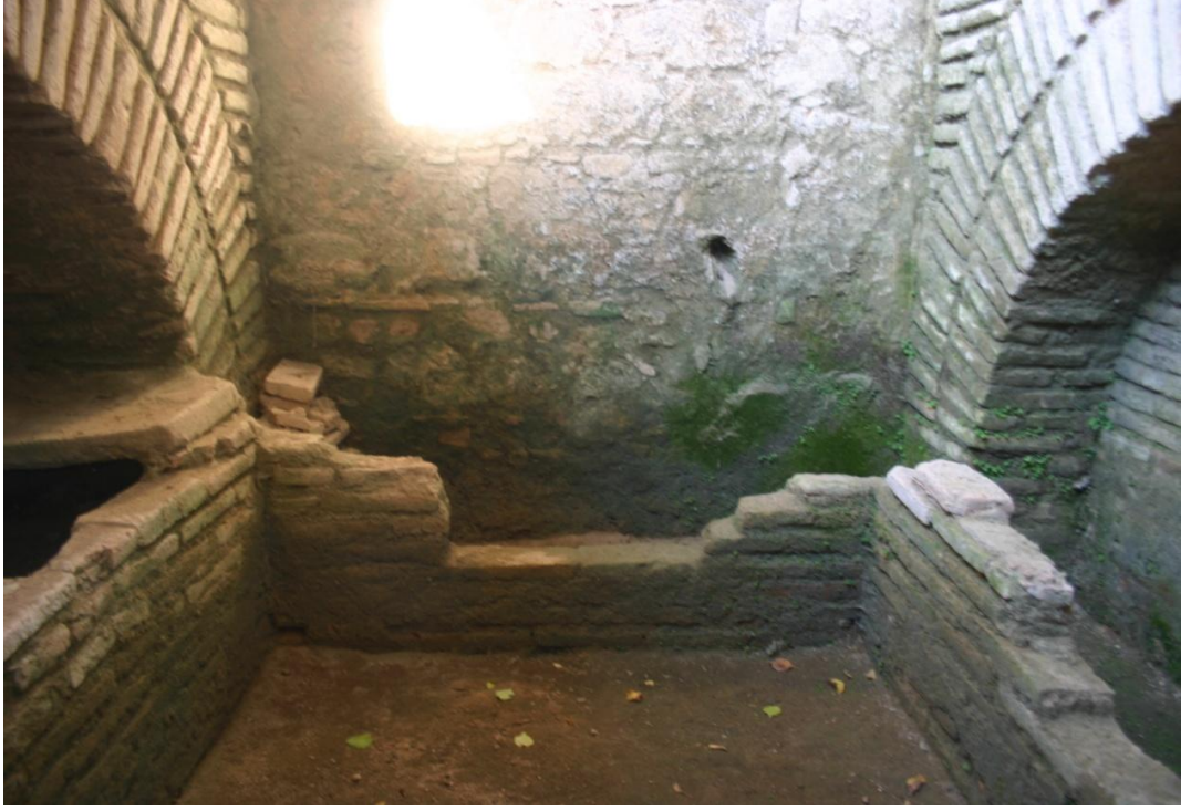
Resim 4.25. M6 kodlu mezar yapısı içi nemden kaynaklı yosun oluşumları
