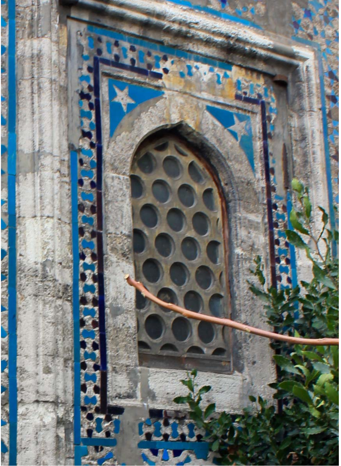
Fotoğraf 4.12 Yapının dođu cephesi tepe pencere çerçevesindeki tuzlanmadan dolayı oluşan çiçeklenme, G. Taşkırın, 2013
