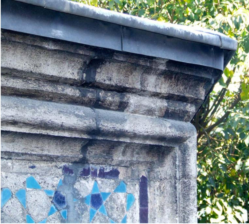
Fotoğraf 4.13 Yapının güneybatı cephesine ait saçak profilindeki kirlenme, G. Taşkiran,2013
