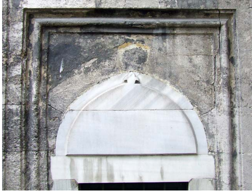
Fotoğraf 4.23 Yapının dođu cephesindeki alt pencere alınlıđında grlen atlaklar ve derz bořlukları, G. Tařkiran, 2013
