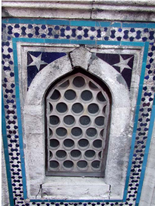
Fotoğraf 4.24 Yapının gneybatı cephesindeki tepe pencerede grlen atlaklar ve derz bořlukları, G. Tařkiran, 2013
