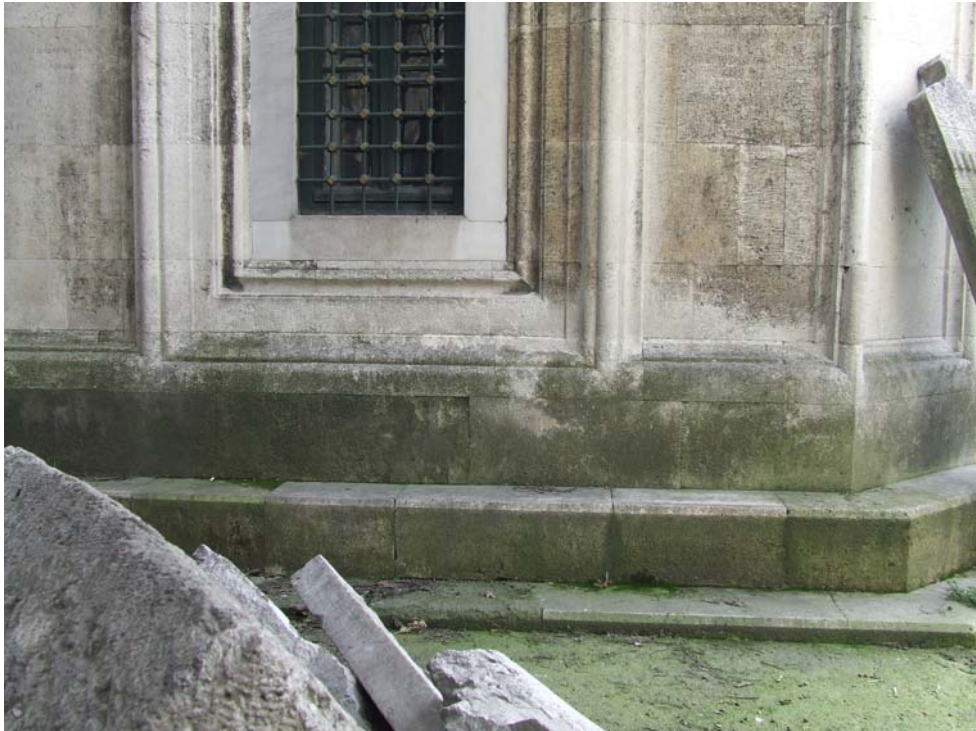
Fotoğraf 4.11 Yapının tm cepyelerindeki su basman tařlarında mevcut olan yosunlařmalar, G. Tařkiran, 2013
