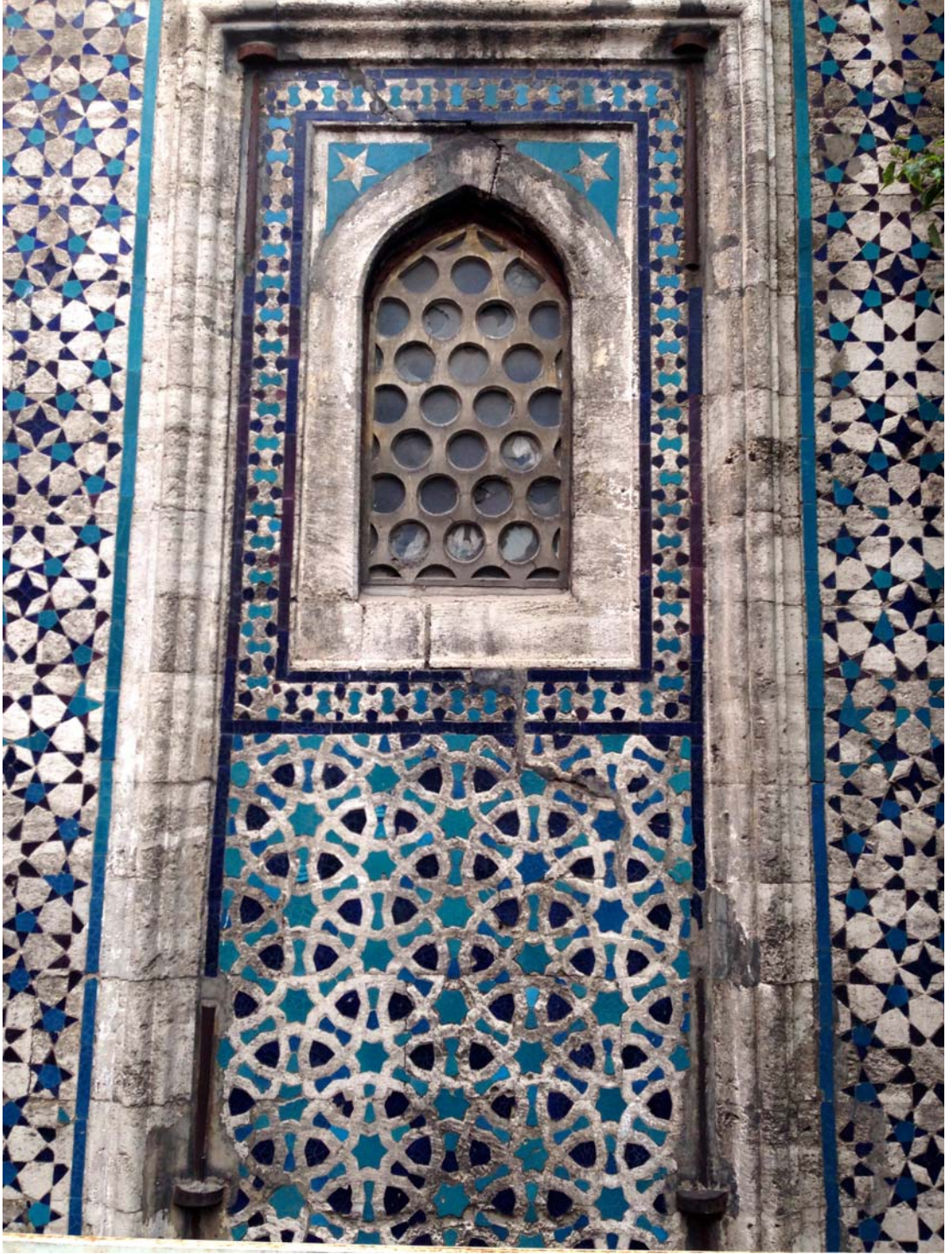
Fotoğraf 4.22 Yapının güney cephesinde görülen çatlaklar ve düşey kılıçlama sistemiyle birlikte çimento katkılı dolguları, G. Taşkiran, 2013
