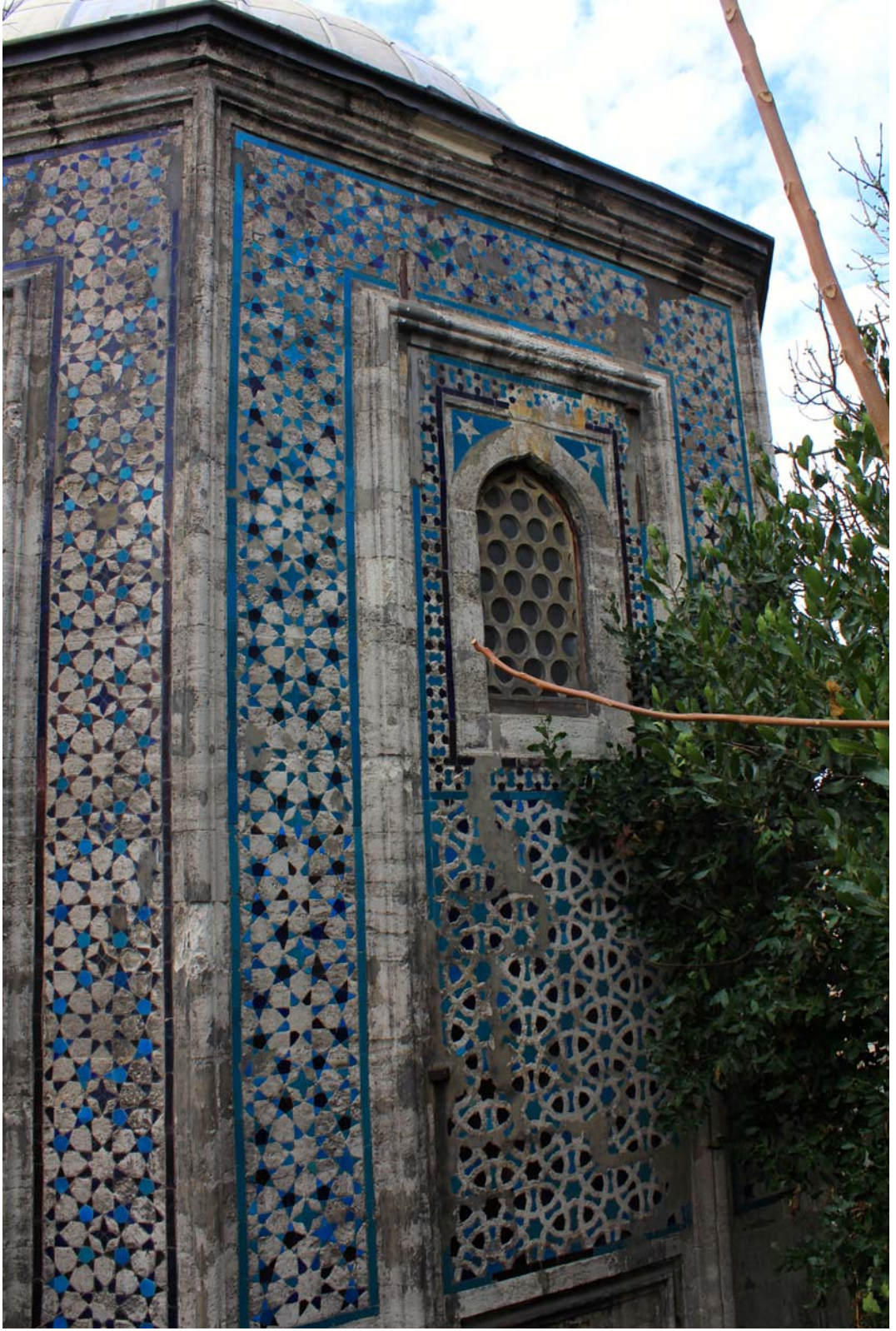
Fotoğraf 4.21 Yapının dođu ve gneydođu cephelerindeki atlaklar ve dşey kılılama sistemiyle birlikte yapılan imento katkılı dolgular, G. Taşkıran, 2013
