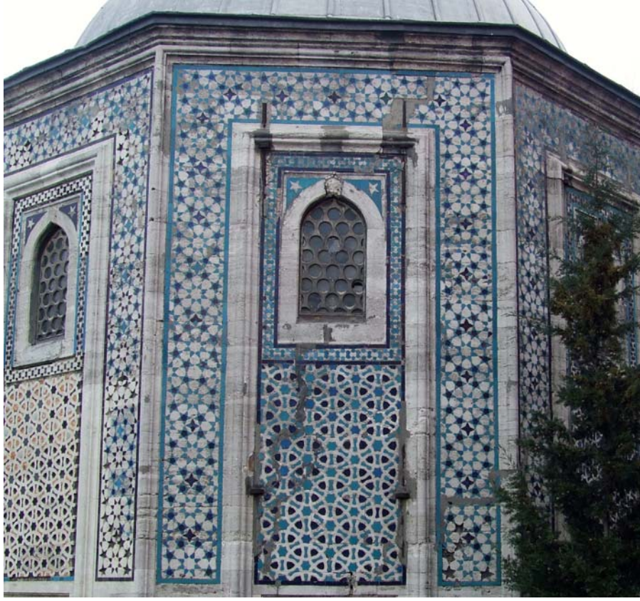
Fotoğraf 4.19 Yapının batı cephesindeki çatlaklar ve düşey kılıçlama sistemiyle birlikte yapılan çimento katkıli dolgular, G. Taşkiran, 2013
