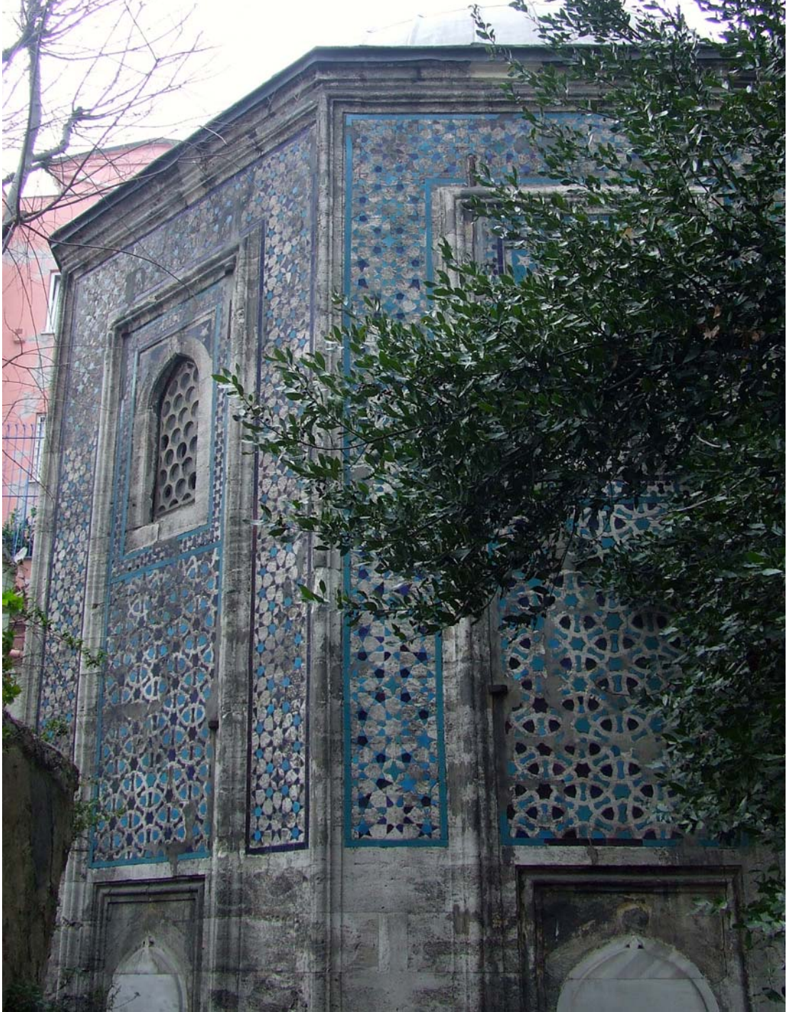
Fotoğraf 4.9 Yapının doğu ve güneydoğu cephelerinde genel olarak mevcut olan kirlenmeler, G. Taşkıran, 2013
