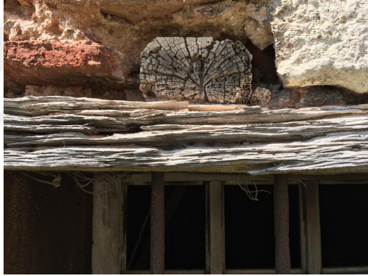
Şekil 2.65. Güneydoğu cephesi, pencere düz atkısı ve hatılda görülen ahşap bozulmaları (böcek tahribatı, malzeme kaybı)
