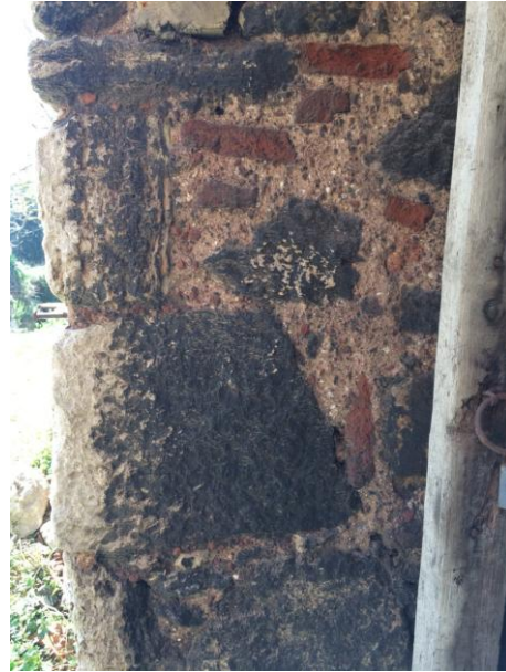
Şekil 2.61. Güneydoğu cephesi kapı çevresinde oluşmuş yüzey kirlilikleri
