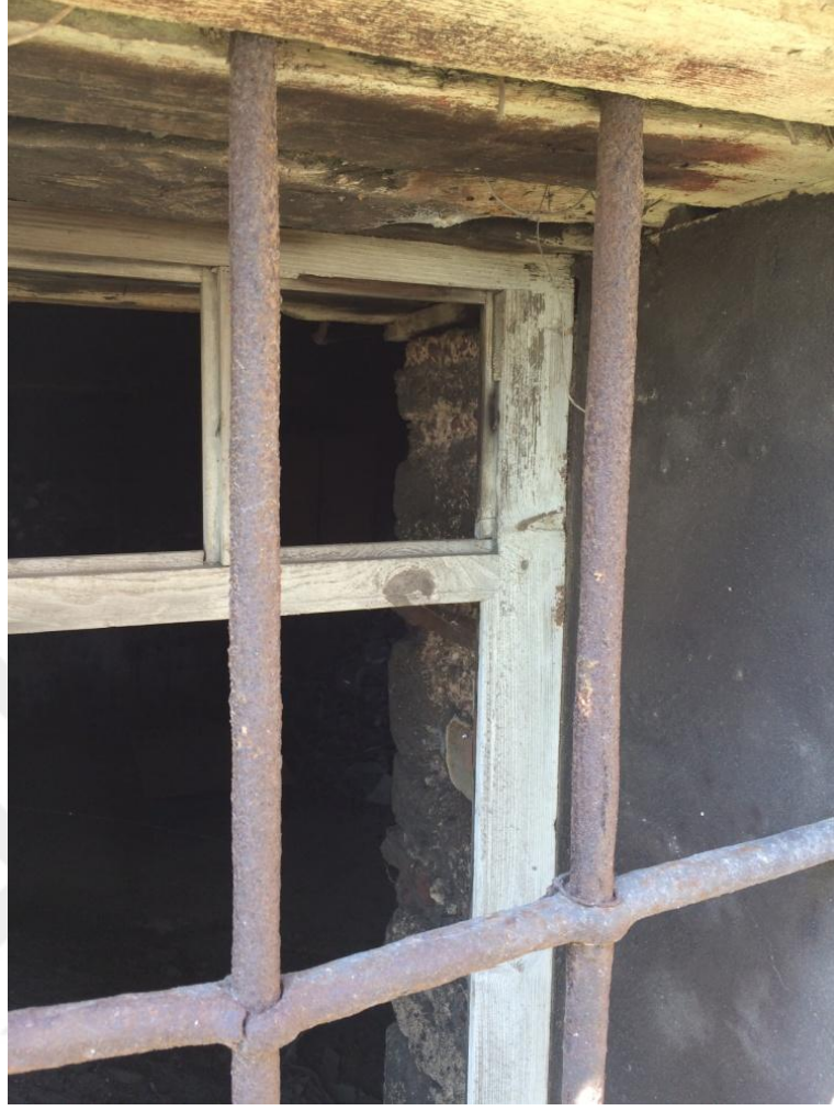
Şekil 2.66. Güneydoğu cephesi metal pencere parmaklıklarında görülen korozyon oluşumu
