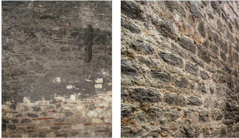
Şekil 2.69. Z01 mekanı duvar yüzeylerindeki is kirliliği (solda) Z02 Mekanı duvar yüzeylerindeki is kirliliği (sağda)
