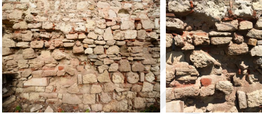
Şekil 2.60. Yapının güneybatı cephesinde oluşmuş örgü boşalmaları ve malzeme kayıpları
