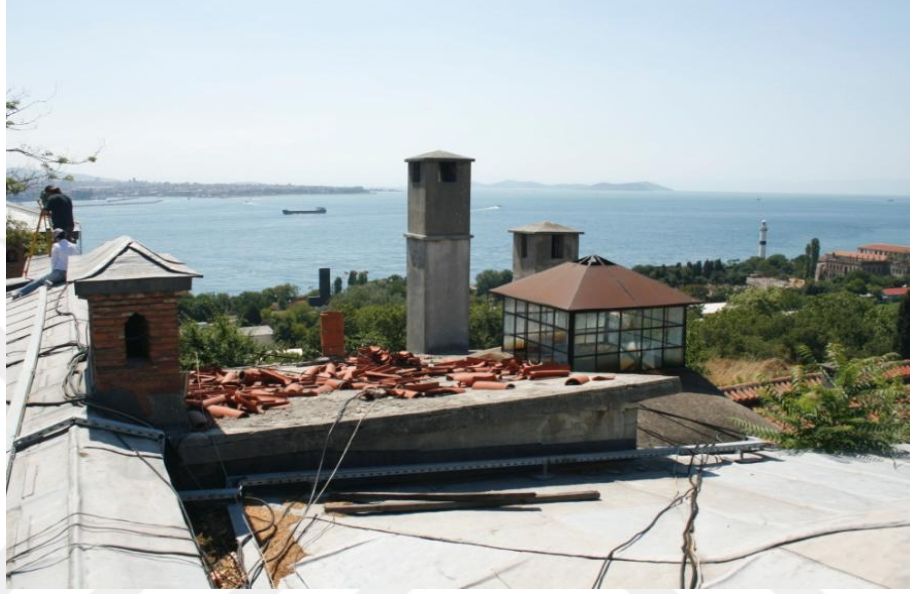
Şekil 2.70. Örtü sisteminde gerçekleştirilmiş niteliksiz müdahaleler (Tures Turizm Planlama ve Restorasyon San. ve Tic. Ltd. Şti. Arşivi, 2009)
