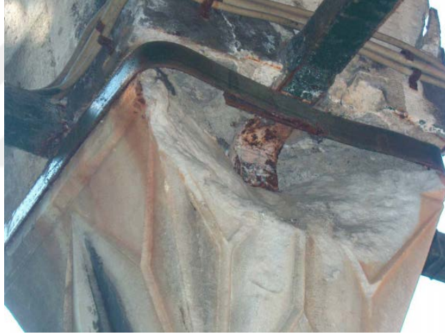
Şekil 3.18 : Gergi hasarı (Bayraktar ve diğ., 2005)
