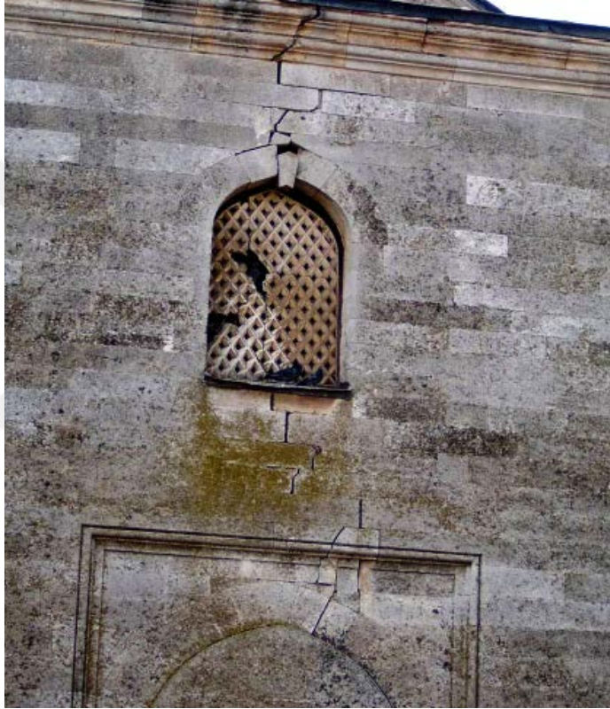
Şekil 3.16 : Yığma yapıda hasar oluşumu (Bayraktar ve diğ., 2005)
