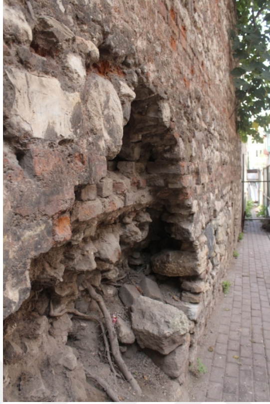
Şekil 3.14 : Yığma duvarın şişmesi ve duvarda oluşan yığma birim dökülmeleri, Fatih/İstanbul (Tetik, 2014)
