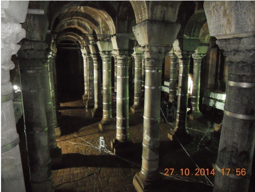
Şekil 3.28 : Sütunlarda çekme çemberi ile güçlendirme örneği
