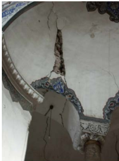
Şekil 3.21 : Küçük Ayasofya Camii kubbe hasarı (Güler ve diğ., 2004)
