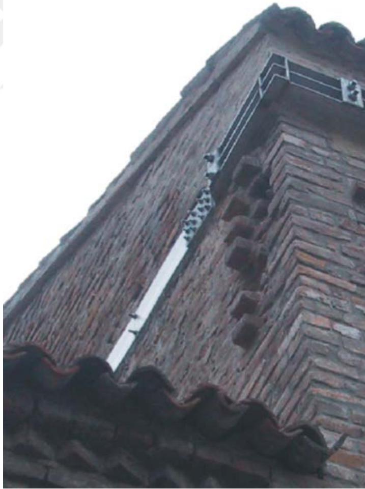
Şekil 3.34 : İtalya Padova Monselice St. Stefano Kilisesi'nin paslanmaz çelik kuşak ile güçlendirilmesi (Modena ve diğ., 2011)
