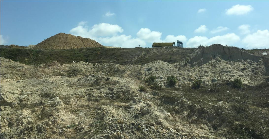
Şekil 5.12 : Kısırkaya’da, kumul ve sulak alanlara komşuluk eden inşaat ve kazı çalışmaları (fotoğraf: Meliz Akyol).
