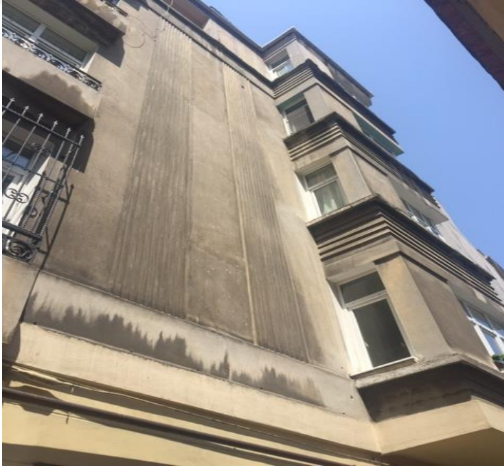
Şekil 3.9: Arslanyatağı Sokak, No:5, Ada:655, Parsel:18
