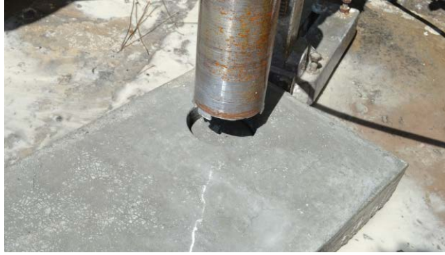
řekil 4.31 : Kür çatlađı bulunan numunelerden karot numune alınması.
