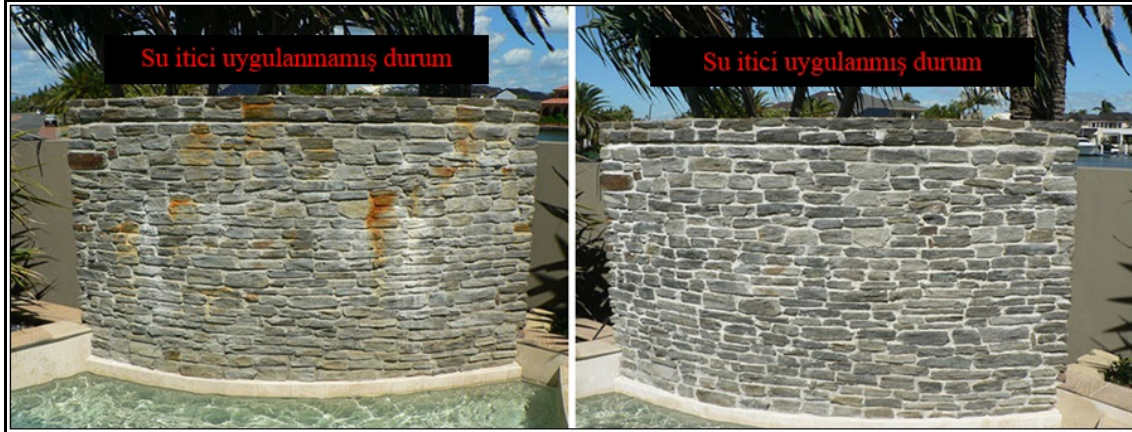
Şekil 5.69 : Pas lekelerinin (solda) önlenmesi için STAIN-PROOF nanoteknoloji esaslı su itici uygulanan (sağda) şist türündeki doğal taşlardan yapılmış olan duvar yapısı (Url-21).
