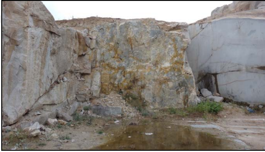
Şekil 4.22 : Hidrotermal alterasyonun yaygın olarak bulunduğu fay zonundan bir görünüm.
