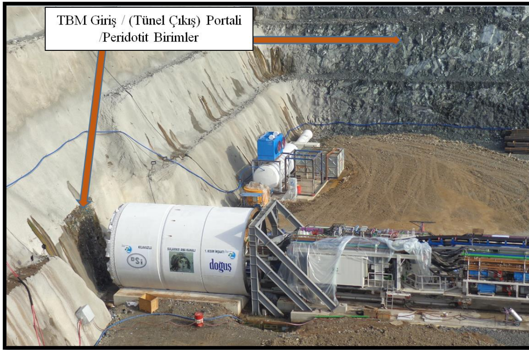
Şekil 3.4: TBM giriş portalı peridotit birimler genel görünüm.
