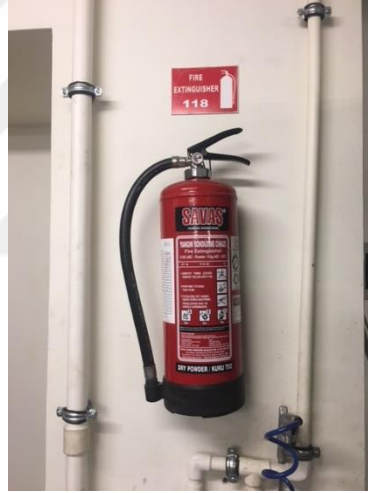
Şekil 6.3 Yangın söndürücü tüp.
