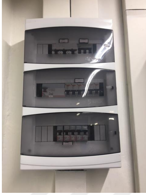
Şekil 6.6 Genel elektrik sistemi elektrik panoları.
