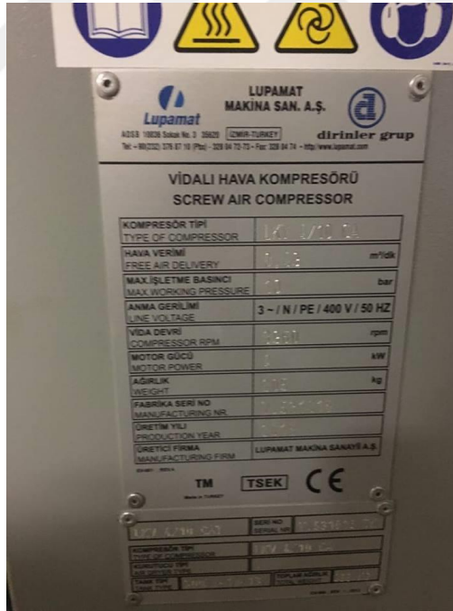
Şekil 6.9 Kompresör bilgi levhası.
