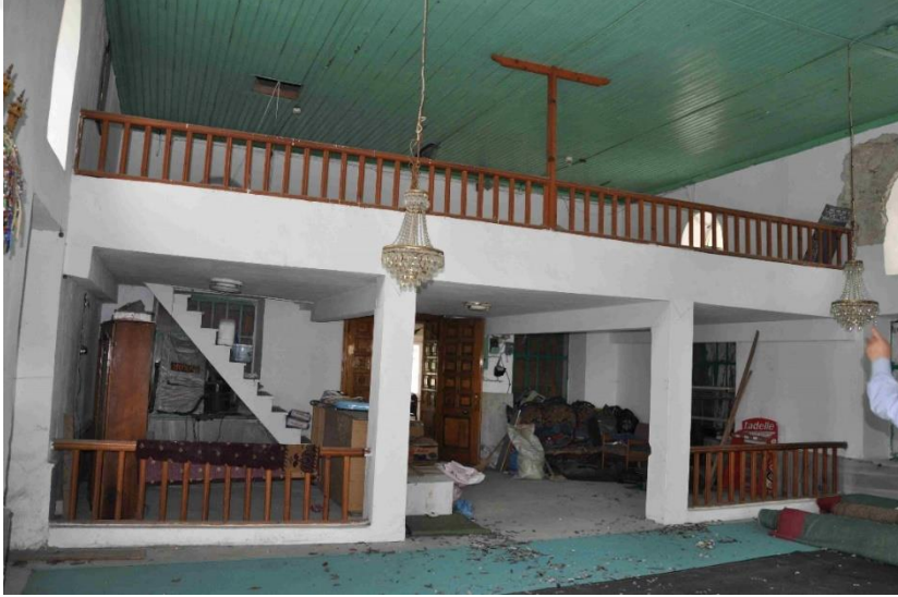
Şekil 3.102 : Haraççı Camisi'nin betonarme kadınlar mahfili ve kuzey cephesinde yanına duvar örülmüş pencereler.
