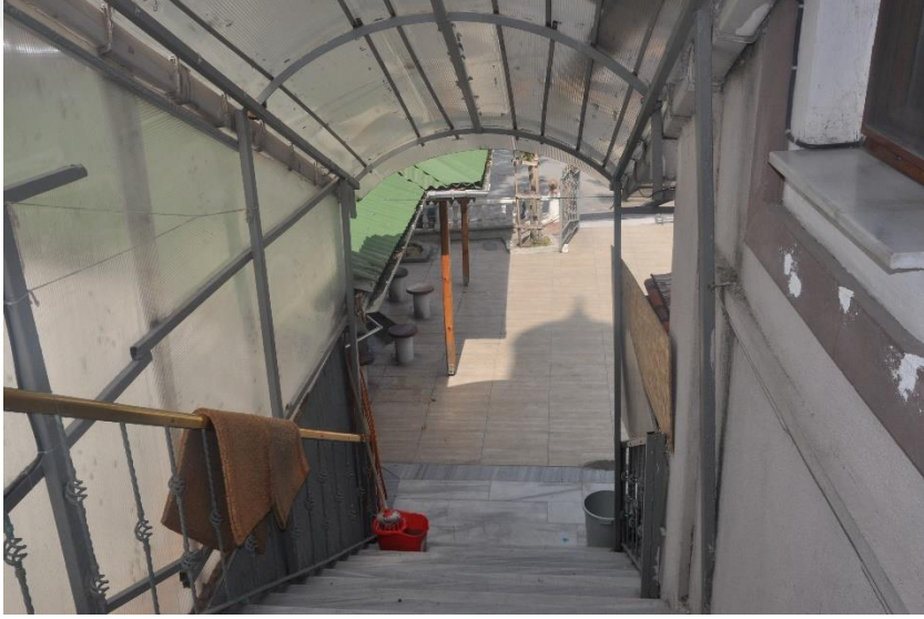
Şekil 4.22 : Muhdes merdivenin üst örtüsünün yapıya bağlantısında, özgün pencereye zarar veren detaylar görülmektedir.
