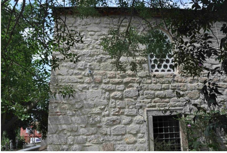
Şekil 3.59 : Baba Nakkaş Camisi'nin güney cephesinde gözlemi devam eden strüktürel çatlaklar.
