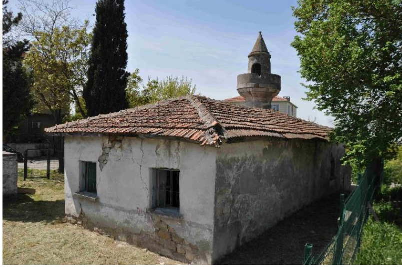
Şekil 3.167 : Çakmaklı Camisi'nin güney cephesinde görülen strüktürel çatlaklar ve dökülmeye başlayan kiremitler.
