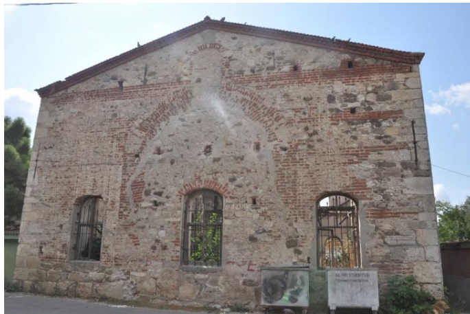
Şekil 3.232 : Seymen Kilise-Camisi'nin, apsisin yıkılıp düz duvara dönüştürüldüğü doğu cephesi.
