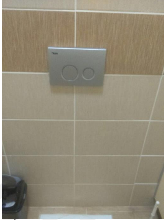
f. İşletme Fakültesi binasında kullanılan rezervuar tipi
