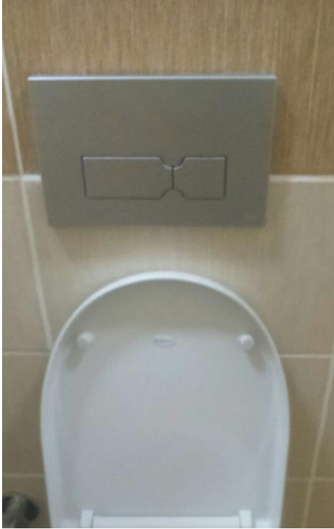
g. Denizcilik Fakültesi binasında kullanılan rezervuar tipi
