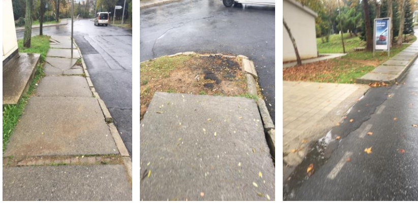
Şekil 4.21 : İTÜ Ayazağa Kampüsü içinde yer alan uygun olmayan yaya yolu yüzeyleri.
