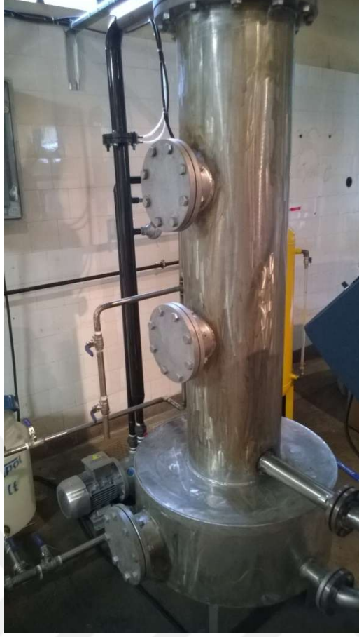
Şekil 3.9: Gaz Yıkama Ünitesi.
