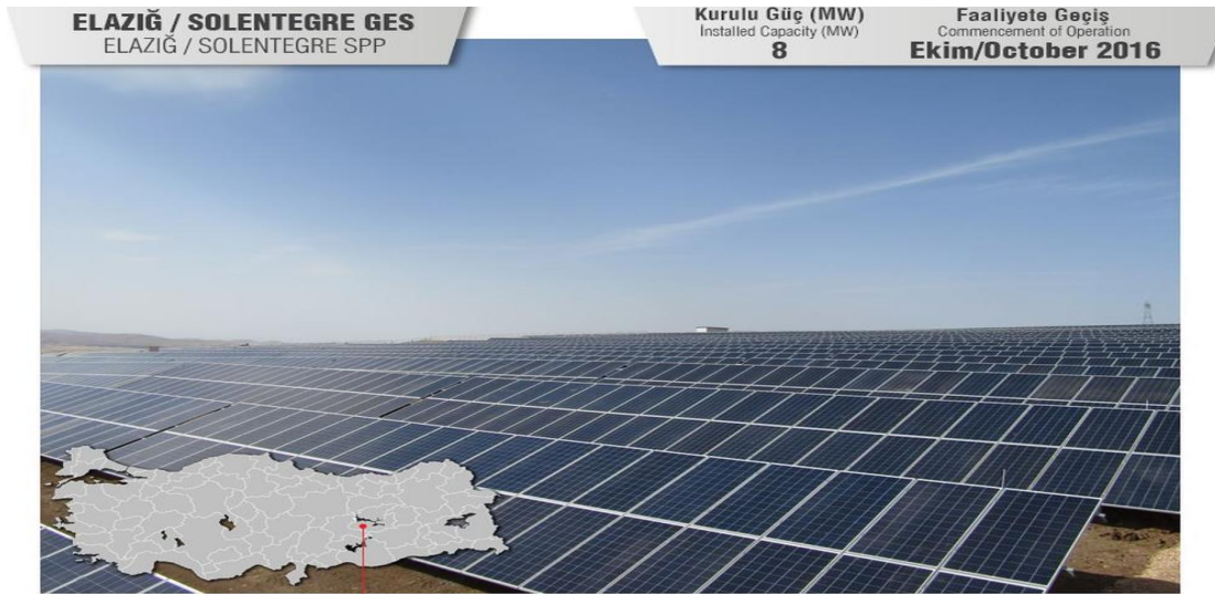
Şekil 6.4: Elazığ Lisanslı Güneş Enerji Santrali.
