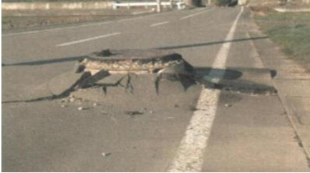
Şekil 2.21 : 2004 Niigata depreminde sıvılaşma nedeniyle oluşan hasar (Mollamahmutoğlu ve Babuçcu, 2006).
