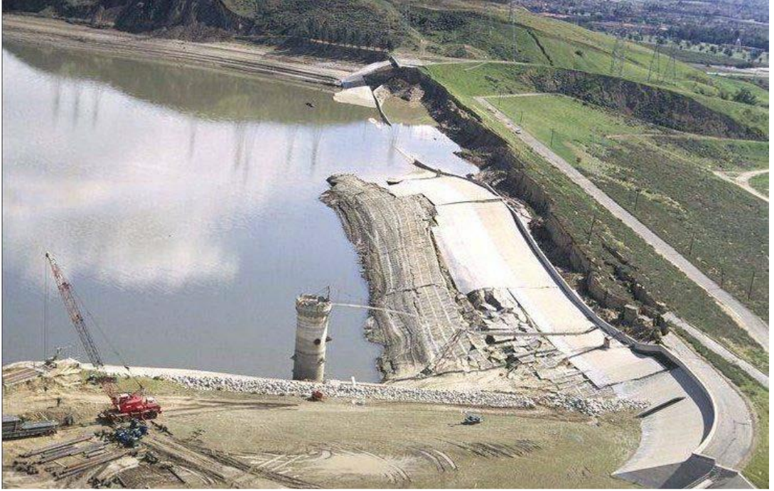
Şekil 2.1 : San Fernando (1971) depreminde sıvılaşma sonucu oluşan hasarlar (Kramer, 1996).
