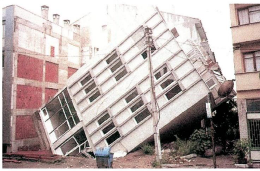
Şekil 2.14 : Adapazarı'nda sıvılaşma nedeniyle oluşan taşıma gücü kaybı ve farklı oturma nedeniyle devrilen yapı (Yasuda, 2004).
