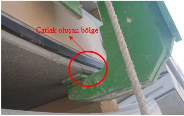
Şekil 4.2: Betonarme prekast bölütlerin yüklenmesi sırasında ortaya çıkan hasar.
