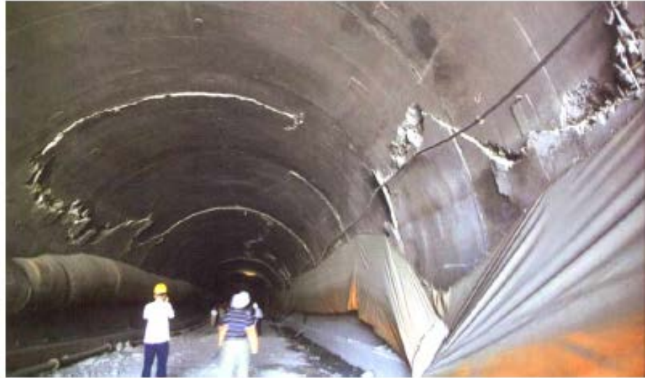
Şekil 4.11: Wenchuan depremi sonrası Longhxi Tünel’inde ortaya çıkan çatlaklar ve kırıklar [28].
