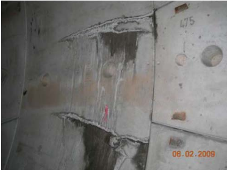
Şekil 4.3: Yapım aşamasında sıralanmış bölüt üzerinde ortaya çıkan çatlaklar [13].
