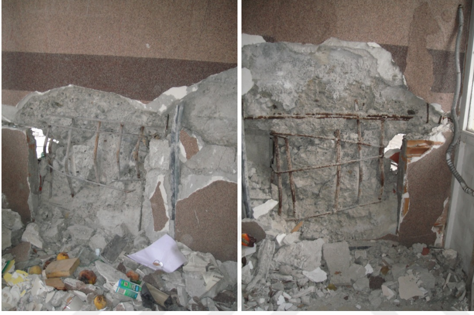
Şekil 4.6 : Bodrum kat S14 (solda) ve S24 kolonları kısa kolon etkisiyle oluşan kesme hasarları.
