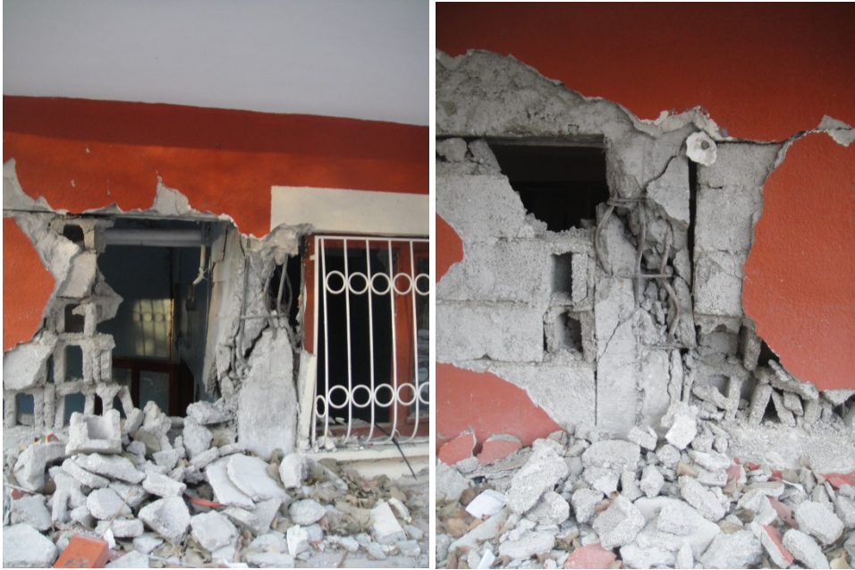
Şekil 4.7 : Bodrum kat S13 (solda) ve S25 kolonları kısa kolon etkisiyle oluşan kesme hasarları.
