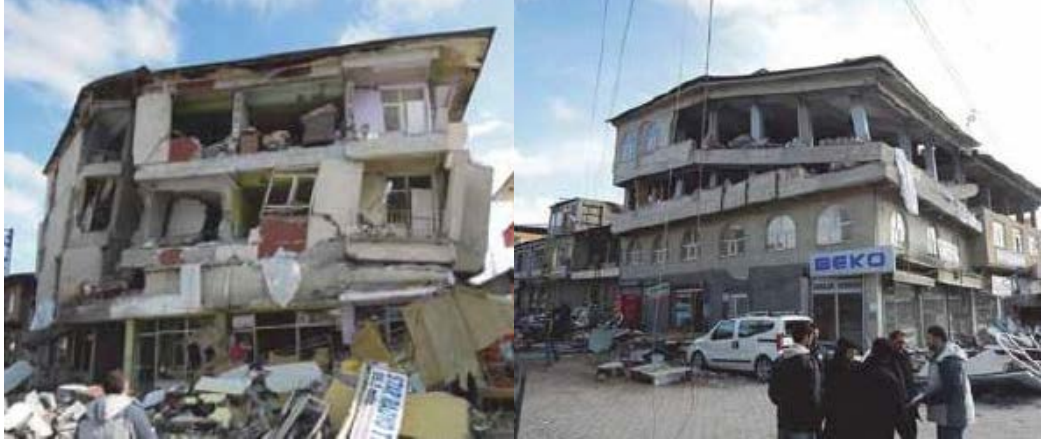
Şekil 3.11 : Zayıf kat üzerine yıkılan binalar [19].
