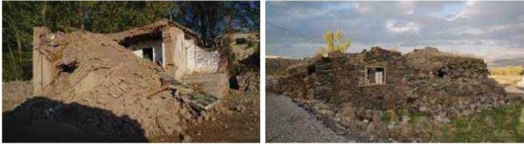
Şekil 3.9 : Dayanımı yetersiz yığma malzemesi kullanımı sonucu ortaya çıkan hasar; solda kerpiç yığma yapı, sağda moloz taş yığma yapı [19].
