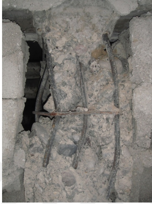
Şekil 4.8 : Bodrum kat S4 kolonu hasarı.
