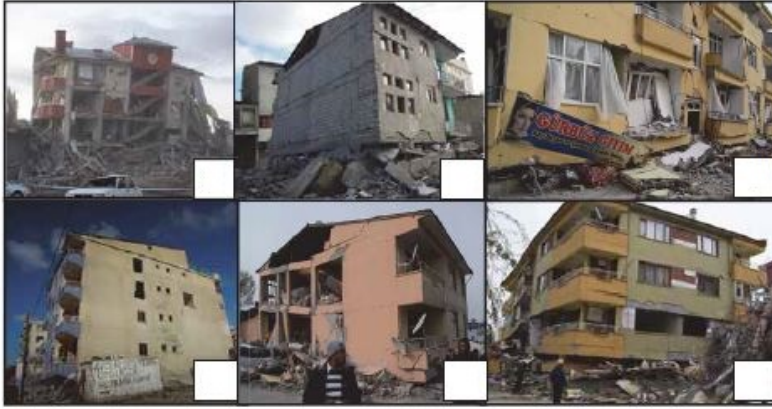
Şekil 3.10 : Yumuşak kat düzensizliğinden dolayı yıkılan binalar [19].
