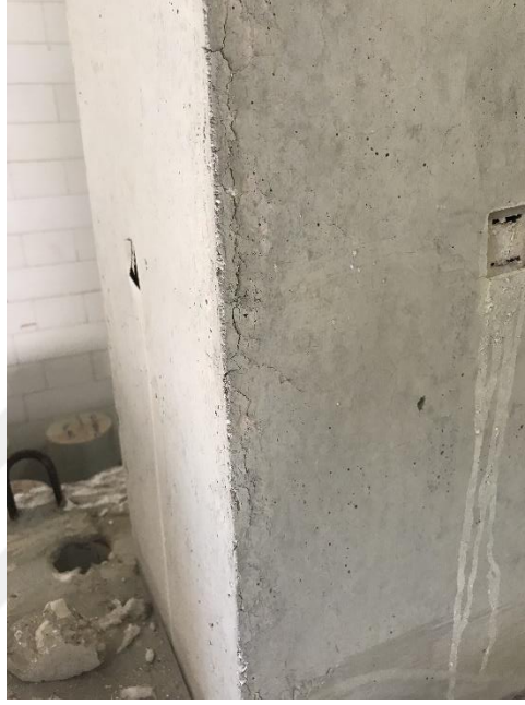
Şekil 3.8 : 60 dakikalık yangın senaryosu deneyi sonrası numune görünümü.
