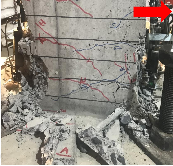
Şekil 4.8 : GDA-REF %5 öteleme oranı çekme sonrası batı (W) yüzünde oluşan ezilme hasarı.
