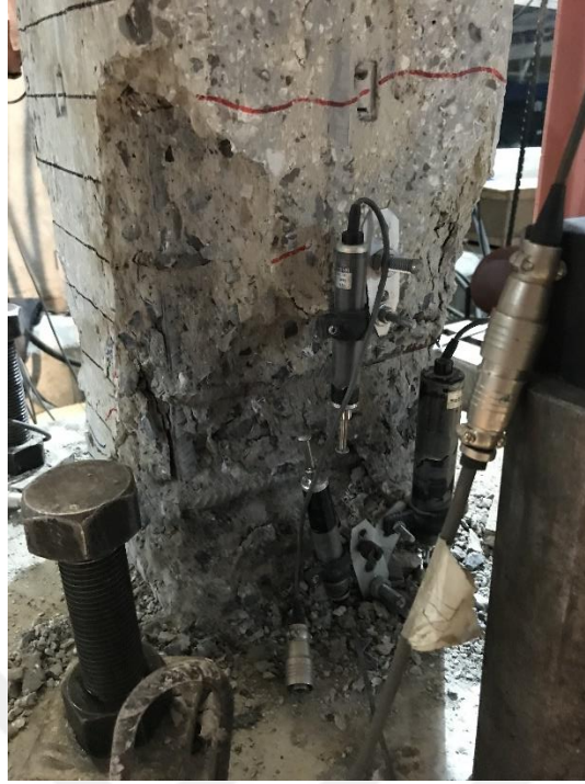
Şekil 4.67 : GDA-90M numunesi %5 öteleme oranı çekme güney (S) yüzündeki hasar görünümü.
