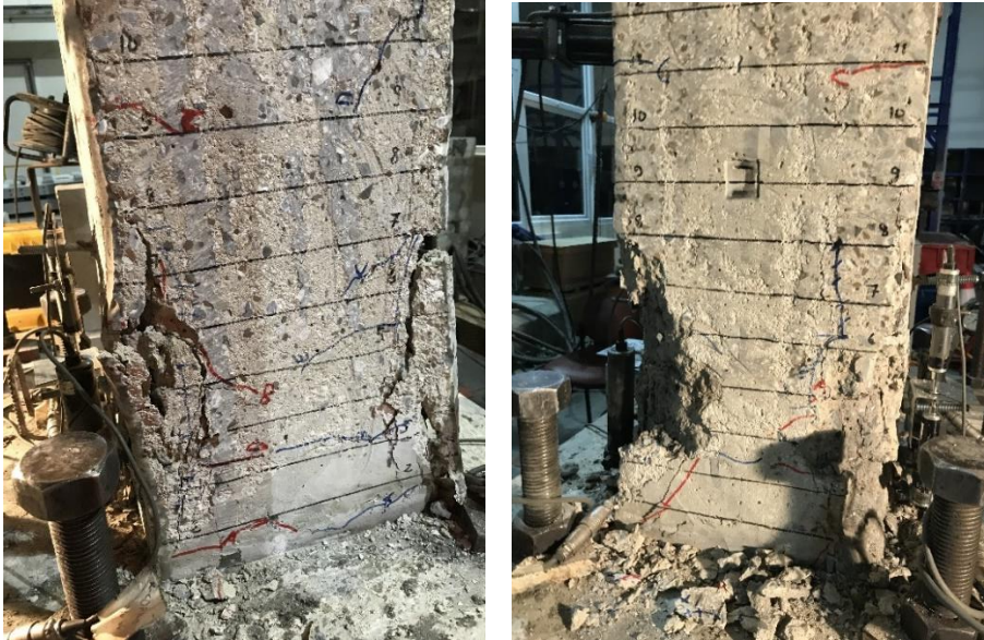
Şekil 4.65 : GDA-90M numunesi %4 öteleme oranı doğu (E) ve batı (W) yüzlerinin hasar görünümü.
