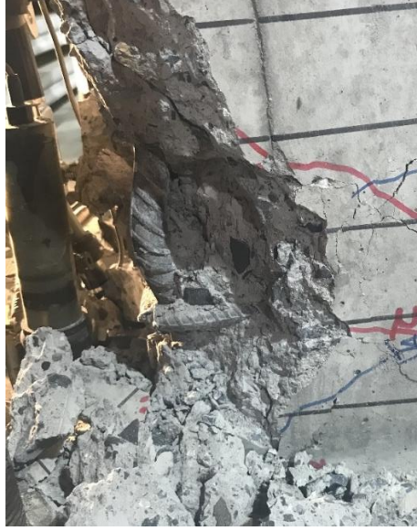
Şekil 4.9 : GDA-REF %6 öteleme oranı itme sonrası güney (S) ve doğu (E) birleşimindeki donatı burkulması.
