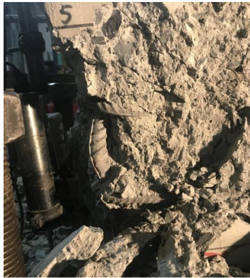
Şekil 4.10 : GDA-REF %7 öteleme oranı itme sonrası güney (S) ve doğu (E) birleşimindeki donatı burkulması.
