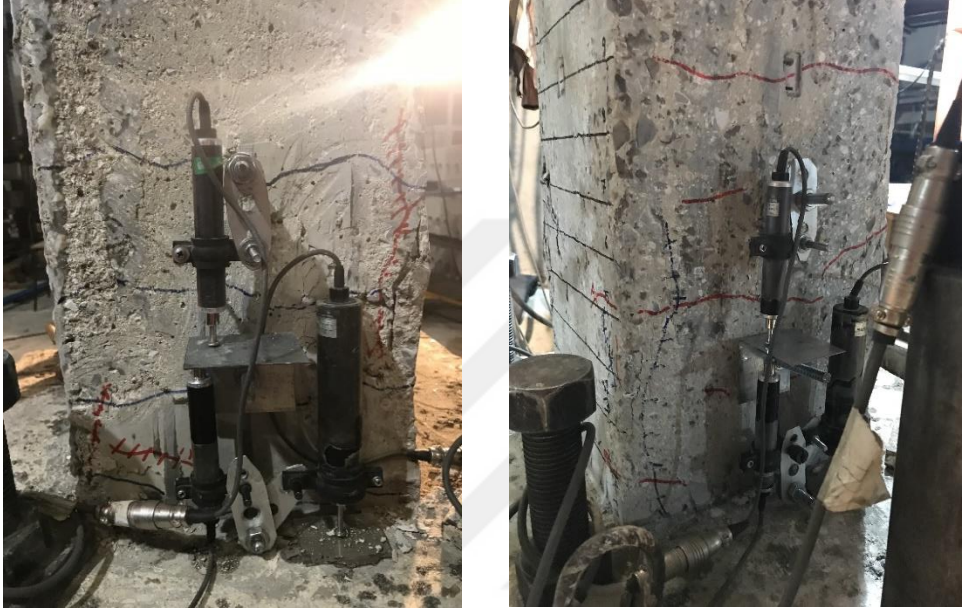
Şekil 4.60 : GDA-90M numunesi %2 öteleme oranı kuzey (N) ve güney (S) yüzlerinin hasar görünümü.
