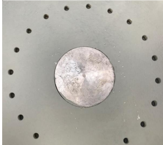
Şekil 2.11: Deprem yalıtım birimine çakılmış bir kurşun çekirdek.
