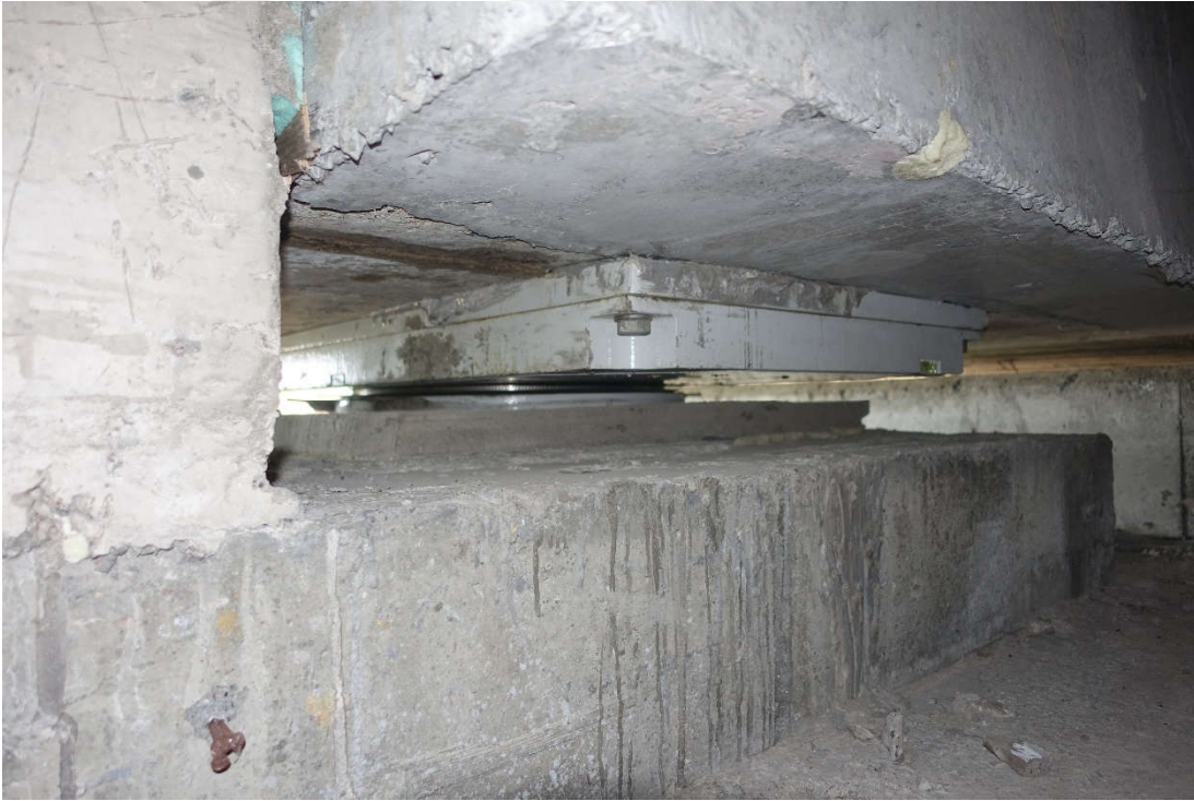
Şekil 3.8: Kuzey Marmara Otoyolu V17 Viyadüğüne ait kayıcı mesnet.
