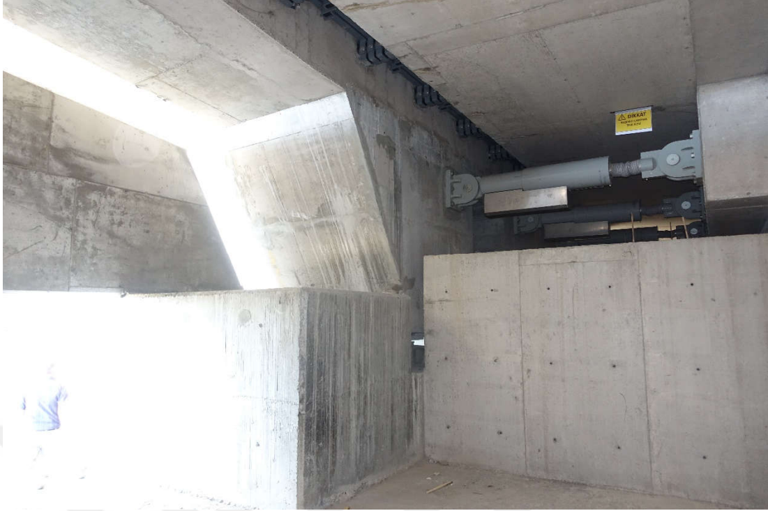
Şekil 3.9: Kuzey Marmara Otoyolu V17 Viyadüğüne ait kenarayak ve üstyapı arasında bulunan hidrolik viskoz damperler.
