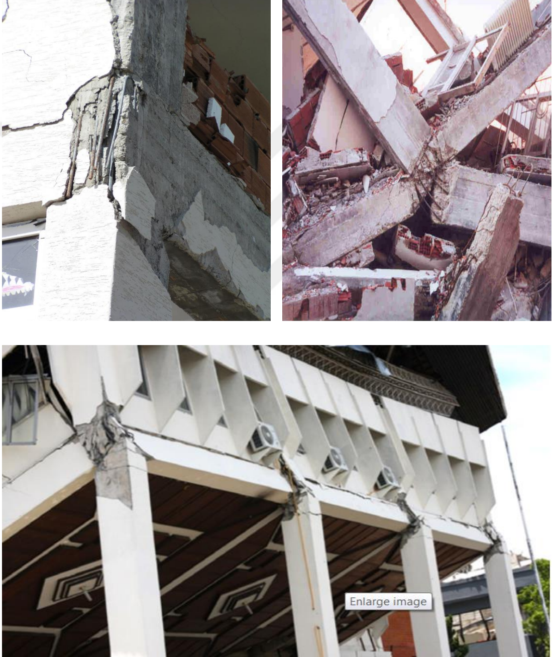
Şekil 11.17 : Kolon kiriş birleşim noktalarında meydana gelen yapısal hasarlar (Gürer, 2012).
