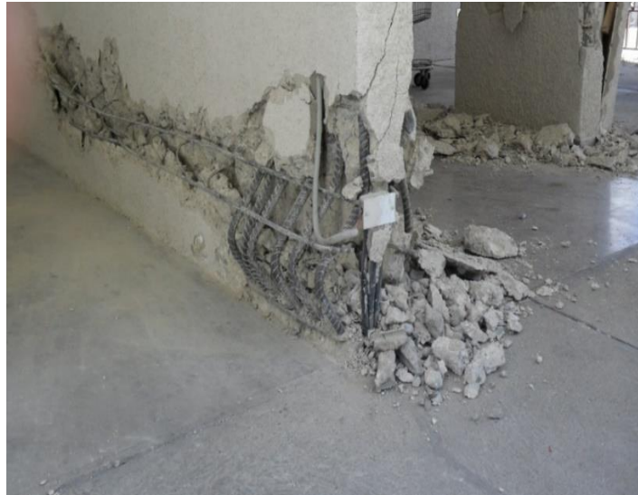
Şekil 11.7 : Perde uç bölgesinde meydana gelen eğilme göçmesi ( Harris ve diğ., 2011).
