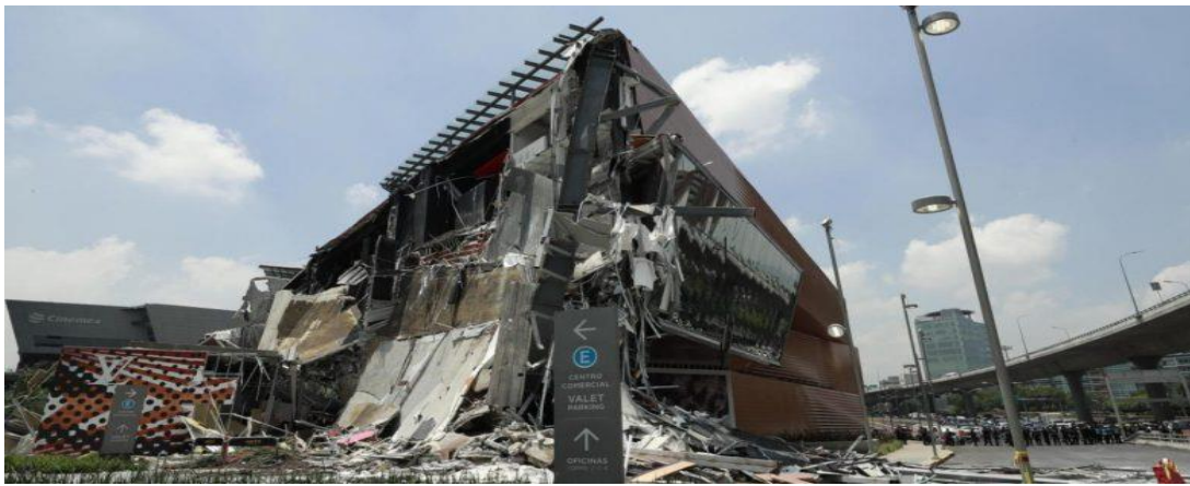
Şekil 4.5 : 2017 Meksika City Depremi'nde aşırı konsol çıkıntısı olan bir alışveriş merkezinde meydana gelen göçme (Cruz, 2018).
