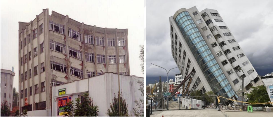
Şekil 2.10 : (a)1999 Kocaeli Depremi sonrasında burulma hasarı gözlenen kamu binası (Çağatay ve diğ., 2011). (b) 1999 Chi Chi Depremi sonrasında burulma hasarı gözlemlenen bir bina ( Everington, 2018).
