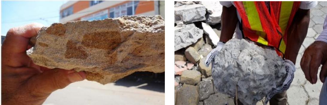
Şekil 11.19 : (a) Segregasyona uğramış beton (b) Çimento harcı az büyük agregalı beton numunesi (Yepez, 2017).
