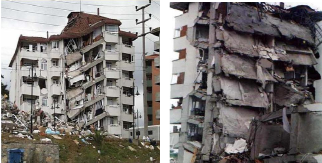
Şekil 3.3 : 1999 Kocaeli Depremi'nde meydana gelen döşeme hasarları (Döndüren ve Nakipoğlu, 2016).
