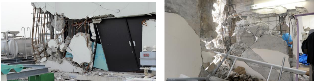
Şekil 11.22 : 2011 Tohoku Depremi’nde yapı malzemesi kaynaklı meydana gelen hasarlar (Swanson, 2011).
