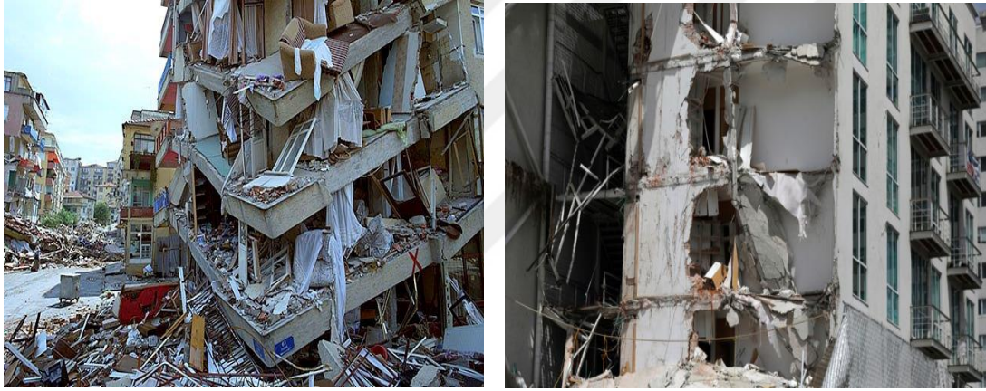
Şekil 4.4 : (a) 1999 Kocaeli Depremi'nde planda çıkıntılar bulunan bir binada meydana gelen deprem hasarı (Döndüren ve Nakipoğlu, 2016).
