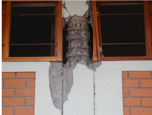
Şekil 10.4 : Deprem hasarı görmüş bant pencere örneği (Pique ve Martel, 2004).
