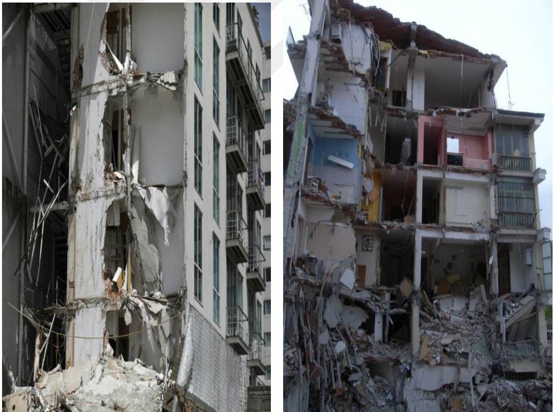
Şekil 3.1 : (a) 2017 Meksika Depremi’nde görülen döşeme hasarı (Burke, 2017). (b) 2009 İtalya L’aquila Depremi’nde meydana gelen döşeme hasarı (Lauro, 2009).
