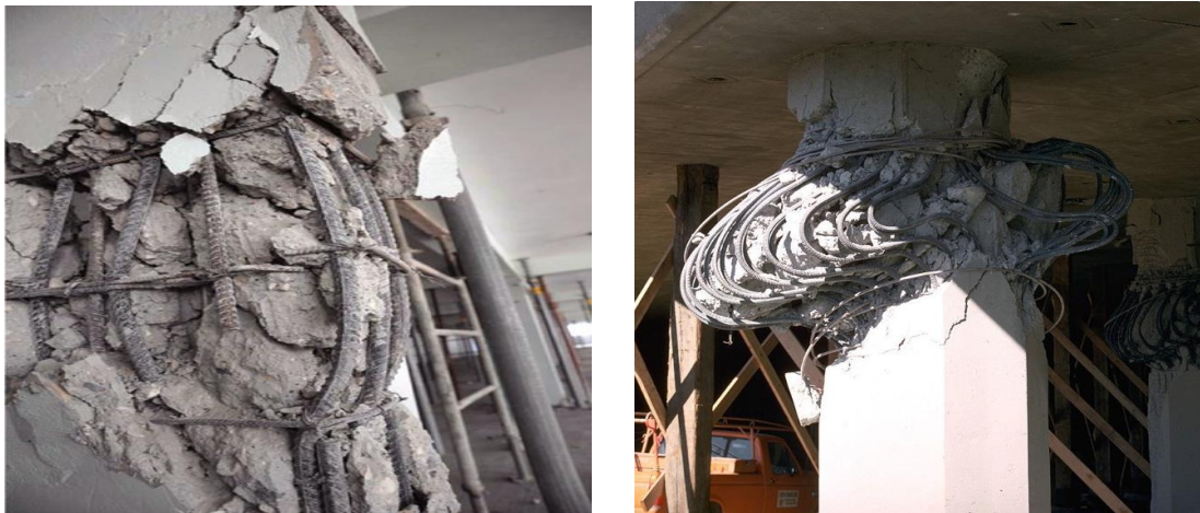
Şekil 11.11 : (a) 2003 Bingöl Depremi basınç göçmesi (Paultre ve diğ., 2010).
