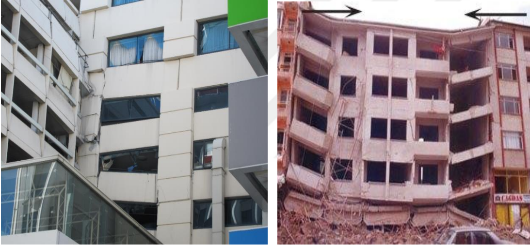
Şekil 9.3 : (a) 2011 Christchurch Depremi'nde çekiçleme etkisi nedeniyle hasar görmüş iş merkezi (Edwin, 2011). (b) 2011 Van Depremi'nde çekiçleme ve yumuşak kat hasarı nedeniyle ağır hasar gören bir bina (Gürer, 2012).
