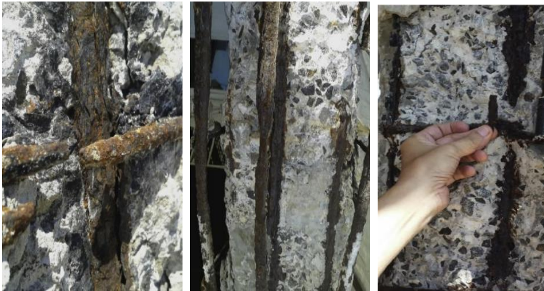
Şekil 11.2 :Korozyona maruz kalmış donatı (Taşdemir ve diğ., 2000).
