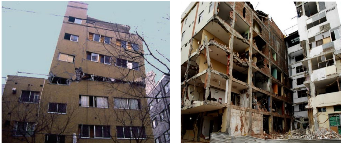
Şekil 7.8 : (a) 1995 Kobe Depremi’nde hasar gören geometrisi düzensiz bina (FEMA, 2012). (b) 2016 Ekvator Depremi’nde kolon süreksizliği bulunan binada görülen hasar (Sim ve diğ., 2016).
