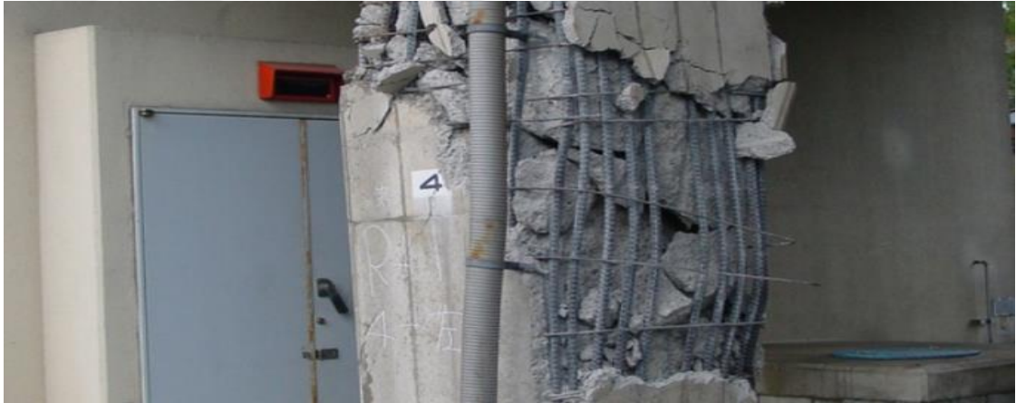
Şekil 11.10: Basınç etkisi altındaki kolonda meydana gelen göçme (Swanson, 2011).
