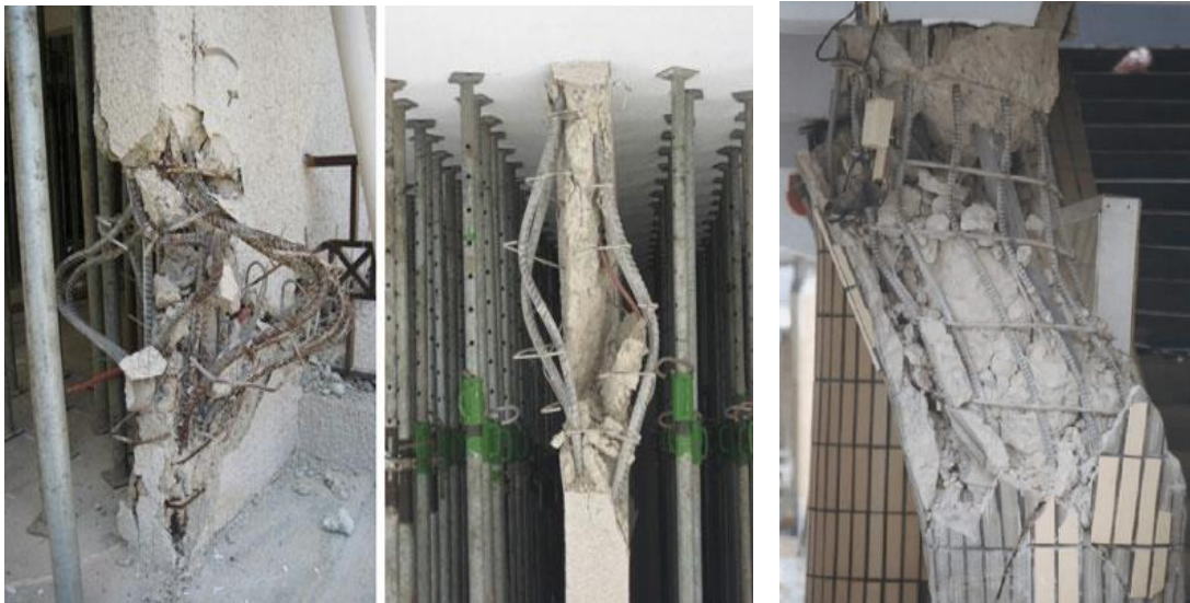
Şekil 11.13 : (a) (b) 2010 Şili Depremi burkulma hasarı ( Harris ve diğ., 2011).
