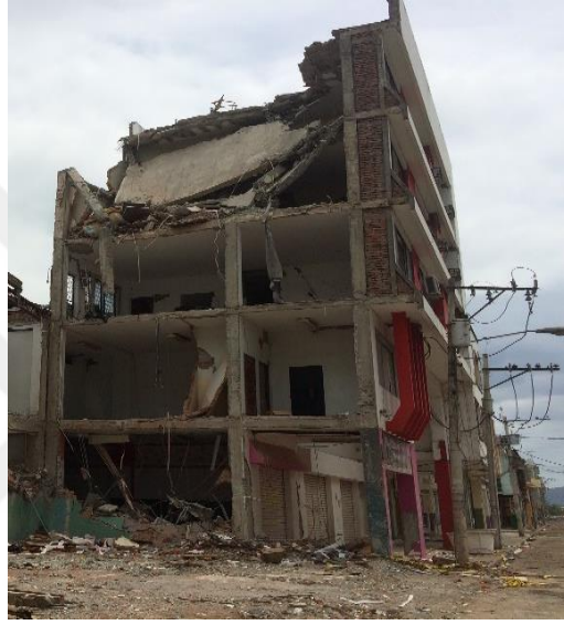
Şekil 3.2 : 2016 Ekvator Depremi döşeme hasarlı bina (Sim ve diğ., 2016).
