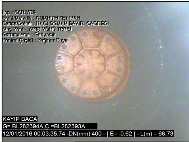
Şekil 12 Asfalt Altında Kalmış Baca Kapağı Görüntüsü
