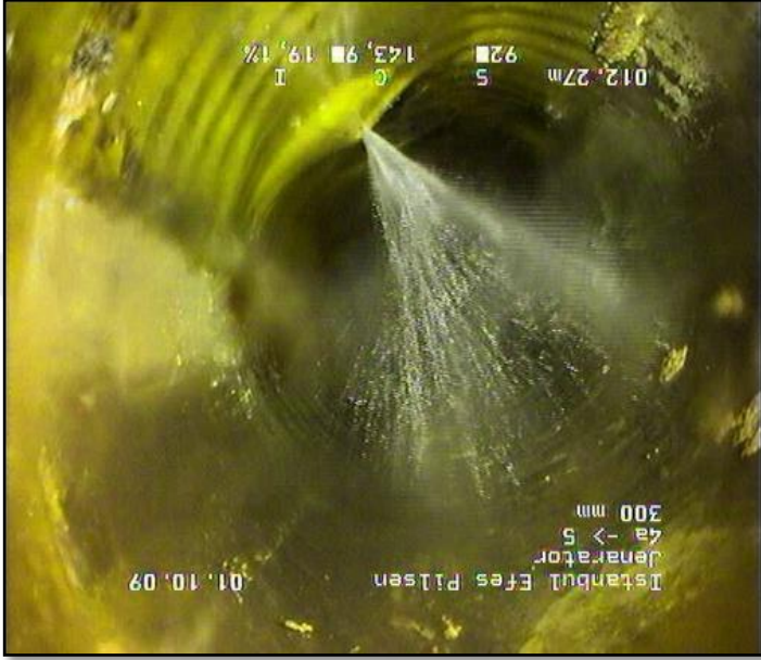
Şekil 13 Boru İine Sızan Şebeke Suyu Kaçağı
