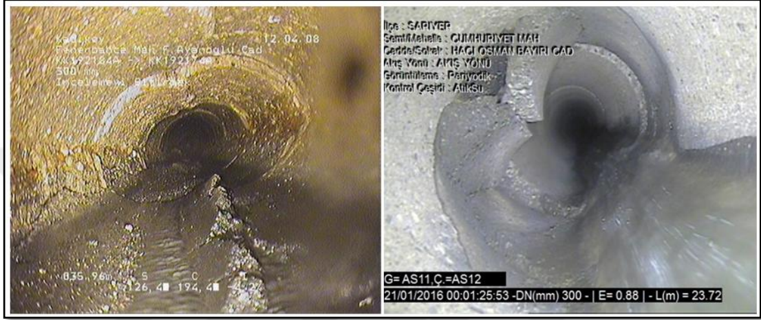
Şekil 7 Yumurta Şeklinde Ezilmiş (solda), kırılmış Beton Boru (sağda)
