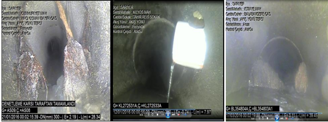
Şekil 14 Boru İçine Girmiş Ağaç Kökleri(sağda ve solda), Boru İçine Fazladan Sokulmuş Rabıt Bağlantısı (ortada)
