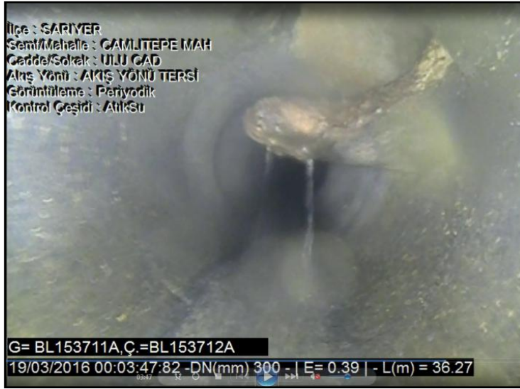
Şekil 5 Kanal içine sızan yeraltı suyu
