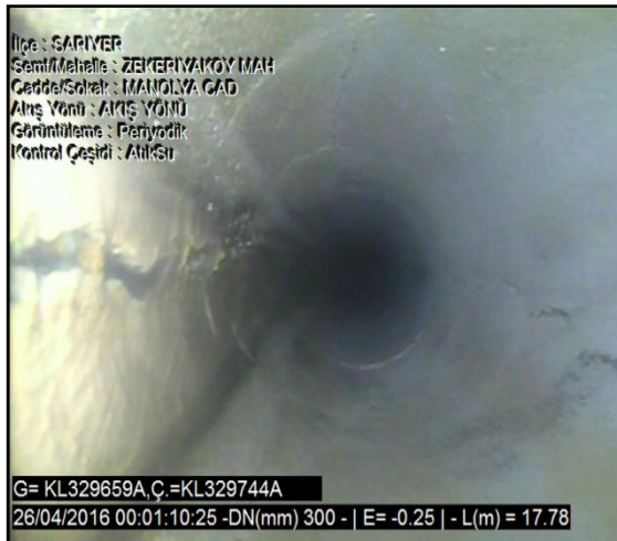
Şekil 3 Dolgu Sırasında Meydana Gelen Çatlak
