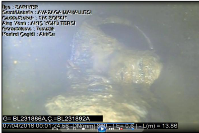
Şekil 8 Atıksu Kanalında Biriken Çamur ve Tortu
