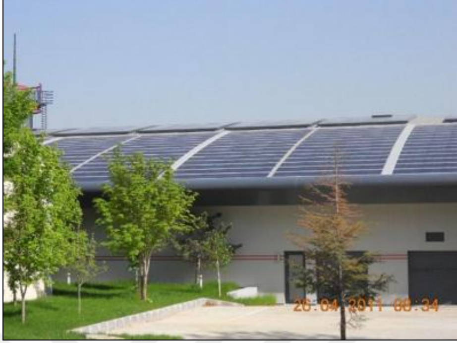
Şekil 3.53 ODTÜ Elektrik ve Elektronik Mühendisliği Fakültesi Ayaşlı Araştırma Merkezi BIPV Uygulaması ( http://www.ntv.com.tr/turkiye/kendi-enerjisini-ureten-binalar,1keNIJJx0G1WSrgcp7kKA )
