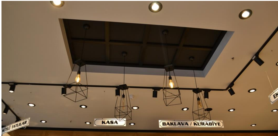
Şekil 4.4.16 Güneşli Şubesi Aydınlatma Armatürü
