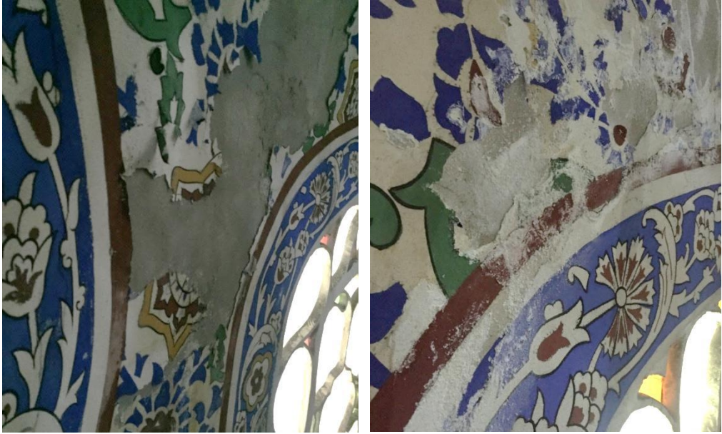
Şekil 6.24: Harimde çimento sıvalı yüzeylerde görülen tuzlanmalar, dökülmeler ve kabarmalar (2018)
