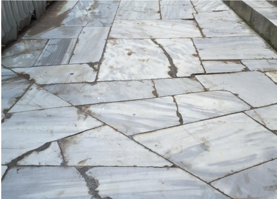
Şekil 6.9: Avlunun mermer zemininde görülen bozulmalar (2018)
