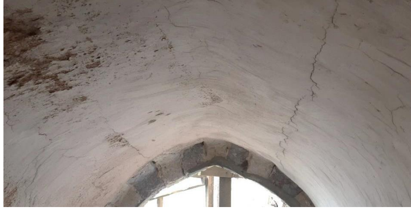
Şekil 6.33: Pencere içi horasan sıvalı yüzeylerde görülen çatlamlar (2018)
