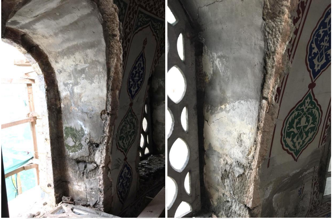
Şekil 6.25: Harimde çimento sıvalı yüzeylerde görülen dökülmeler, kabarmalar, ayrışmalar ve çatlaklar (2018)
