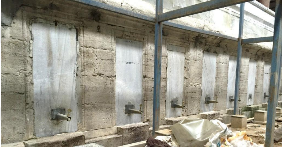
Şekil 6.3: Çeşme aynalarında yapılmış niteliksiz çimento derz ve diğer onarımlar
