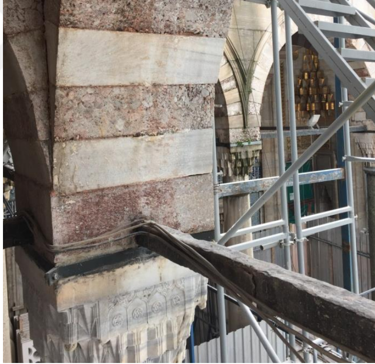
Şekil 6.45: Demir gergilerde görülen korozyon (2018)
