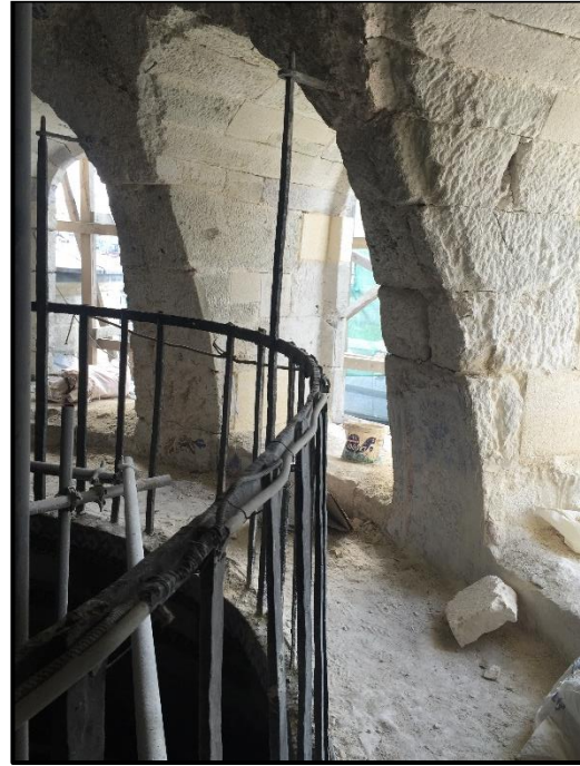
Şekil 5.15b: Dolaşmalık kotu demir korkuluk (2018)
