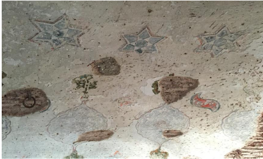
Şekil 6.29: Ana kubbe ve yarım kubbelerde raspa yapılan yüzeyler (2018)
