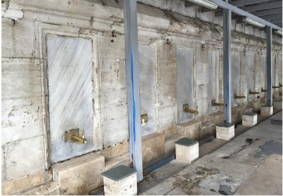
Şekil 4.40: Güneybatı cephesinde yer alan abdest alma muslukları (2018)
