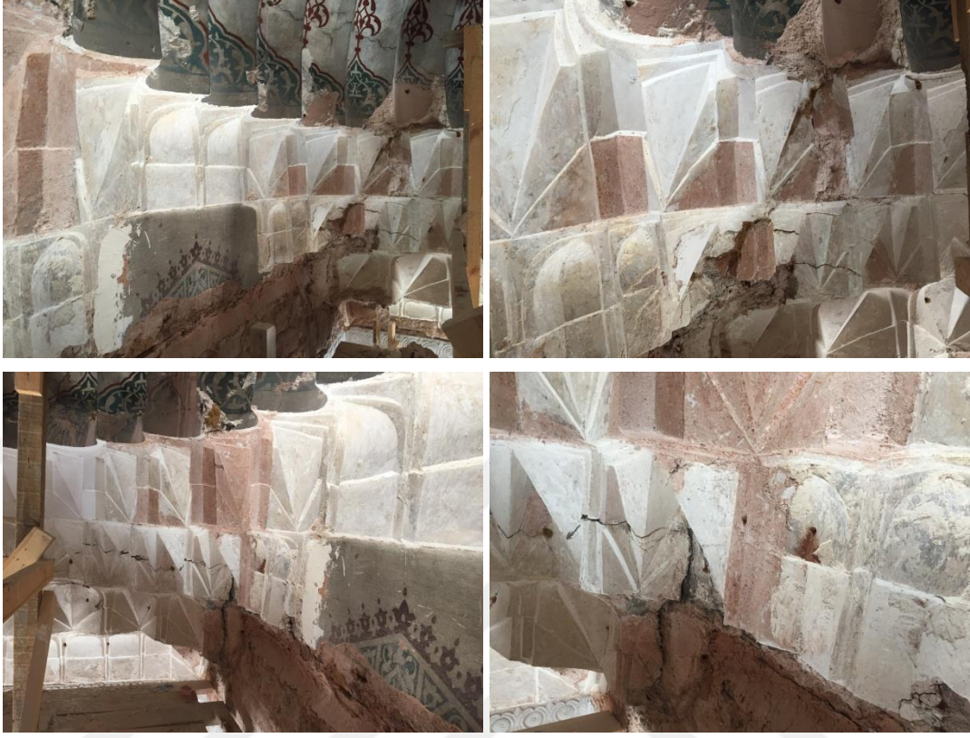
Şekil 6.37: Kuzeybatı taç kapı giriş revağı içerisinde yer alan alçı mukarnas süslemelerde görülen bozulmalar (2018)
