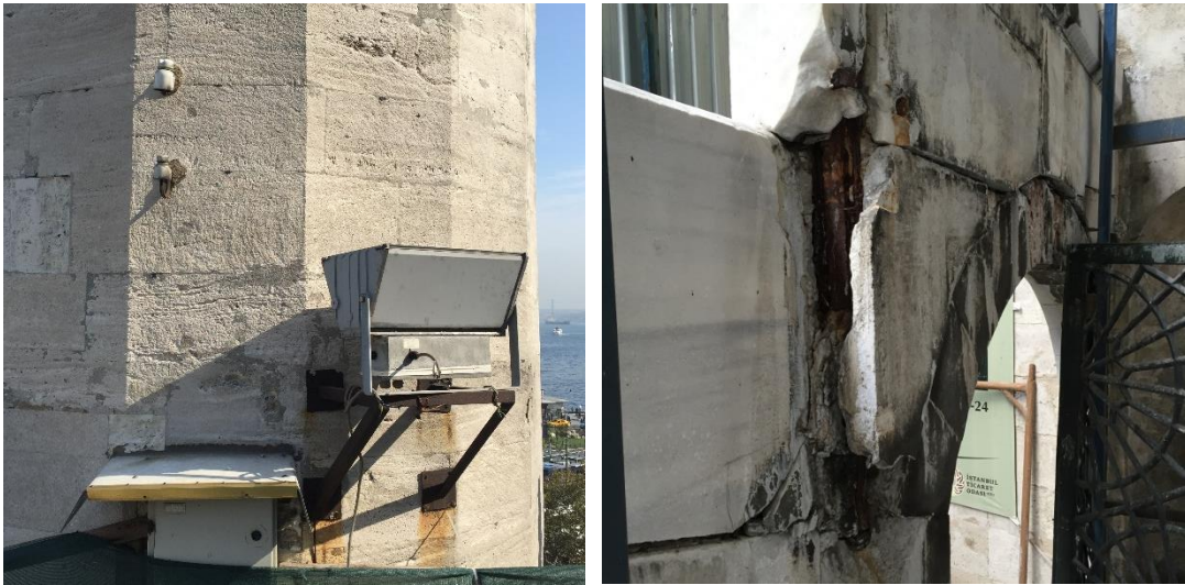
Şekil 6.4: Korozyon sebebiyle taşlarda oluşan pas lekeleri ve çatlamlar
