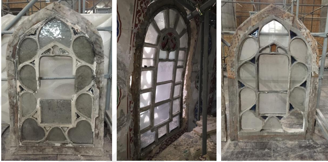
Şekil 6.36: İçlik revzenlerindeki bozulmalar (2018)
