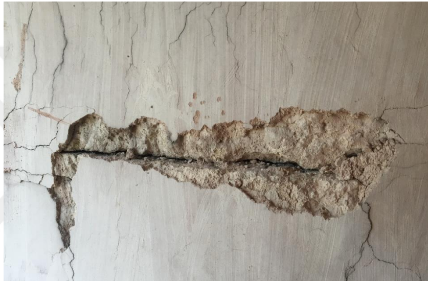
Şekil 6.34: Horasan sıvalı duvar yüzeylerinde görülen çatlamlar (2018)
