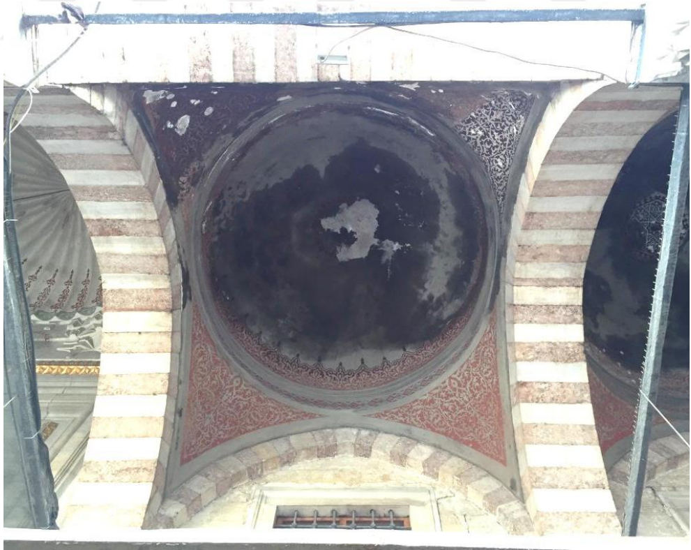
Şekil 6.26: Avlu revak kubbelerinin iç yüzeylerinde görülen sıva bozulmaları (2018)
