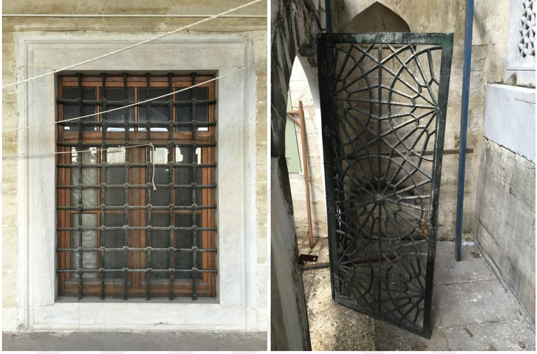
Şekil 6.46: Korozyona uğramış demir pencere ve kapı şebekeleri
