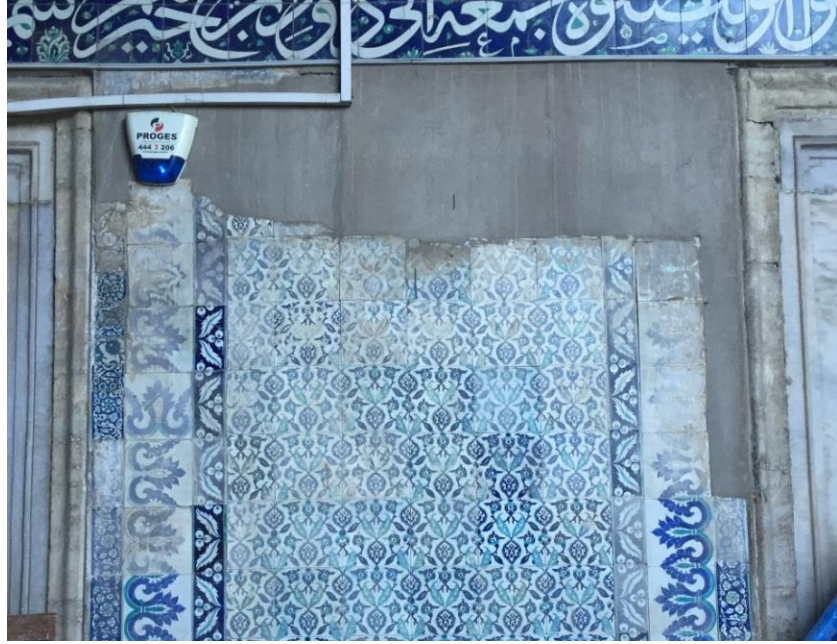
Şekil 6.42: Son cemaat yeri duvar çinilerinde görülen tuzlanma, renk kaybı ve çimento harçlı tabakalar (2018)
