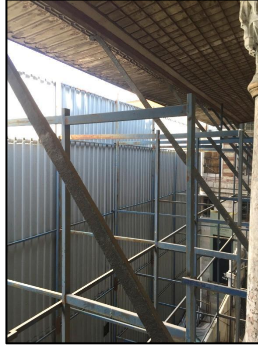
Şekil 5.14b: KD ahşap saçağı taşıyan demir eliböğründeler (2018)
