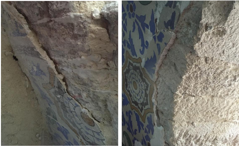
Şekil 6.35: Duvar ile sıva arasında görülen boşluklar (2018)
