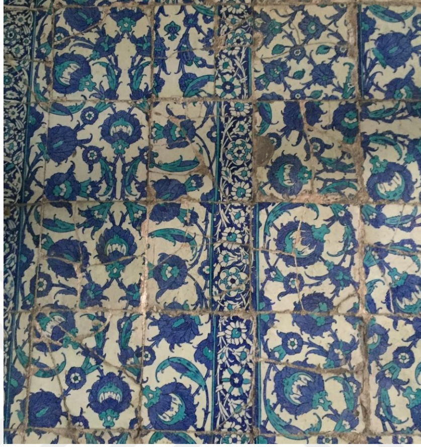
Şekil 6.41: Hünkar mahfili duvarındaki çatlamış çini karolar (2018)
