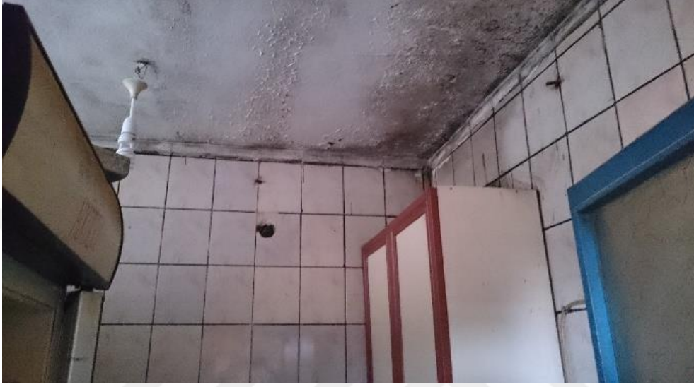
Resim 4.16: Duvar Tavan Kapı Pencere Uygunsuzluğu
