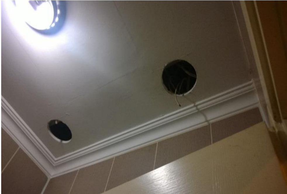
Resim 4.15: Aydınlatma Elektrik Uygunsuzluğu
