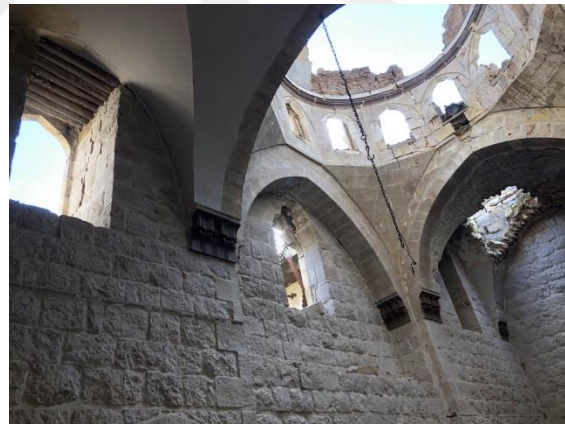
(Şekil 3.53):Vekil Evinin Hasarlı Kubbesi (Ocak-2019).
