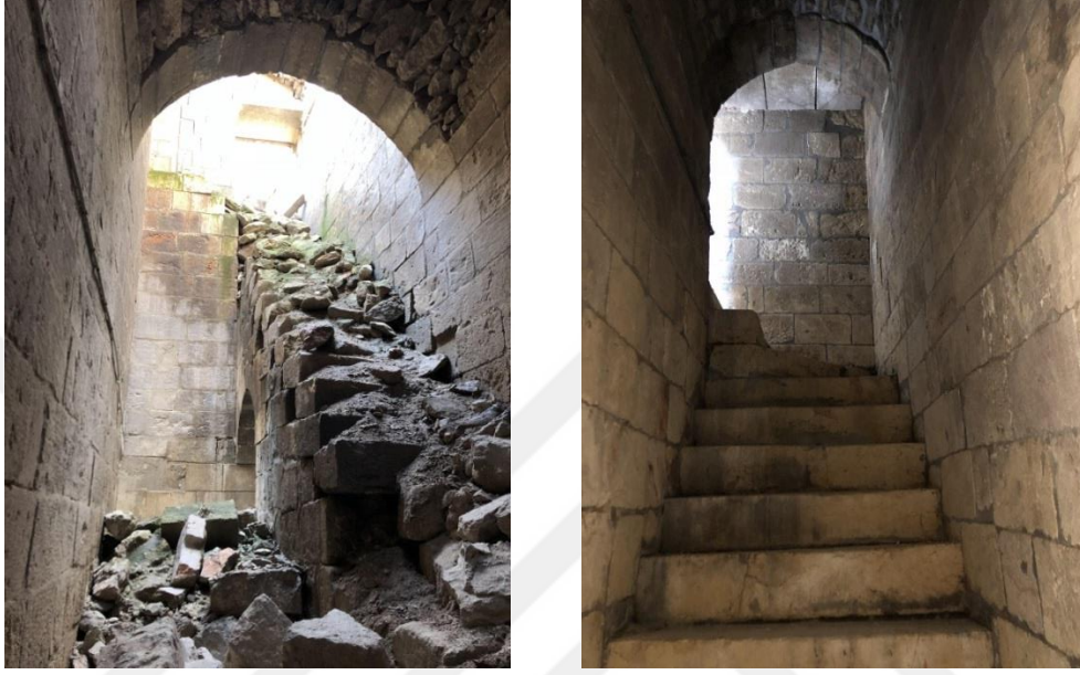
(Şekil 3.9) :Firdevs Binanın Merdivenlerin Hasarı(Ocak-2019).
