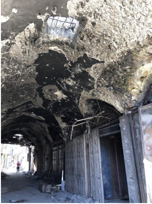
(Şekil 3.76):Kapalı Çarşıda Hasar Durumu(Nisan-2018).
