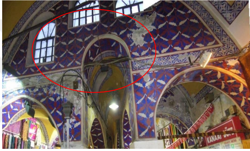
Resim 5.66: Sokaklardaki Sıvalı Yüzeylerde Dökülmeler 2019 (Kişisel Arşiv)
