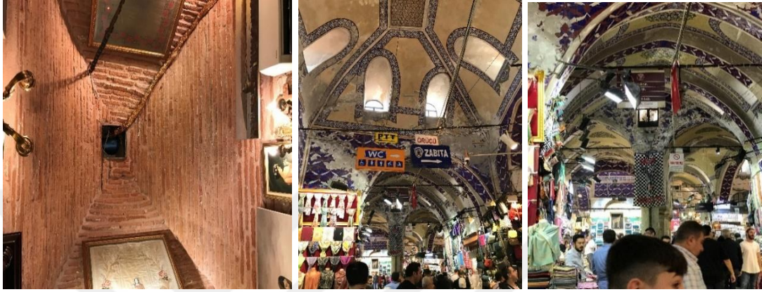
Resim 5.56: Cevahir Bedesteninde bulunan suni havalandırma bacası, Rutubetin oluşturduğu hava kirliliği ve kaplamaların düşmesi sonucu oluşan tehlikeler (Kişisel Arşiv).
