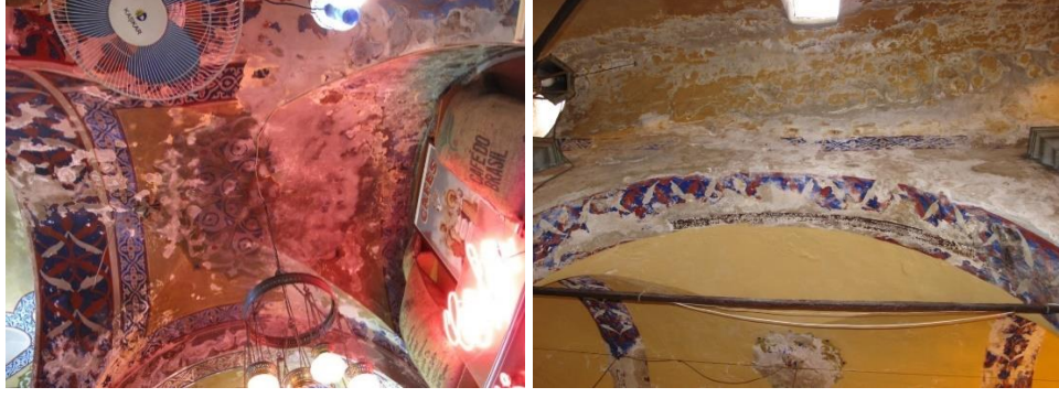
Resim 5.65: Sokaklardaki Sıvalı Yüzeylerde Dökülmeler (Kişisel Arşiv, 2019)
