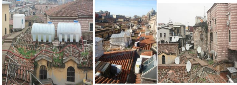
Resim E.75: Kapalıçarşı Onarım Öncesi Çatı Durumu; Su depoları, Kablolar, Antenler ve Klimaların Oluşturduğu Hasarlar
