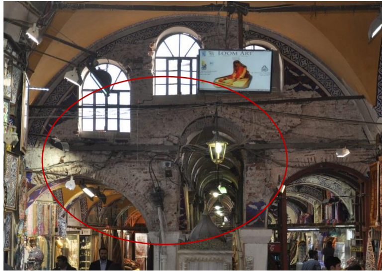
Resim 5.67: Sokaklardaki Sıvalı Yüzeylerde Dökülmeler (Kişisel Arşiv, 2019)
