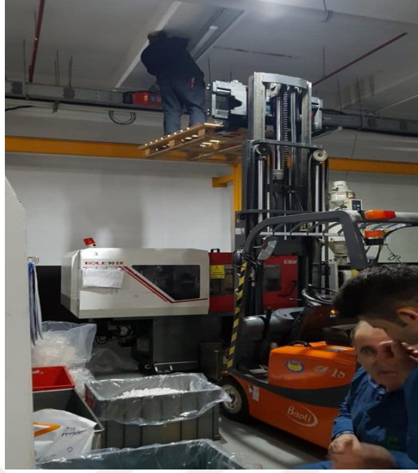
Resim4.32 Forklift insan taşıma sepeti olmayan çalışma(M.Akcan Çelik, 2019)
