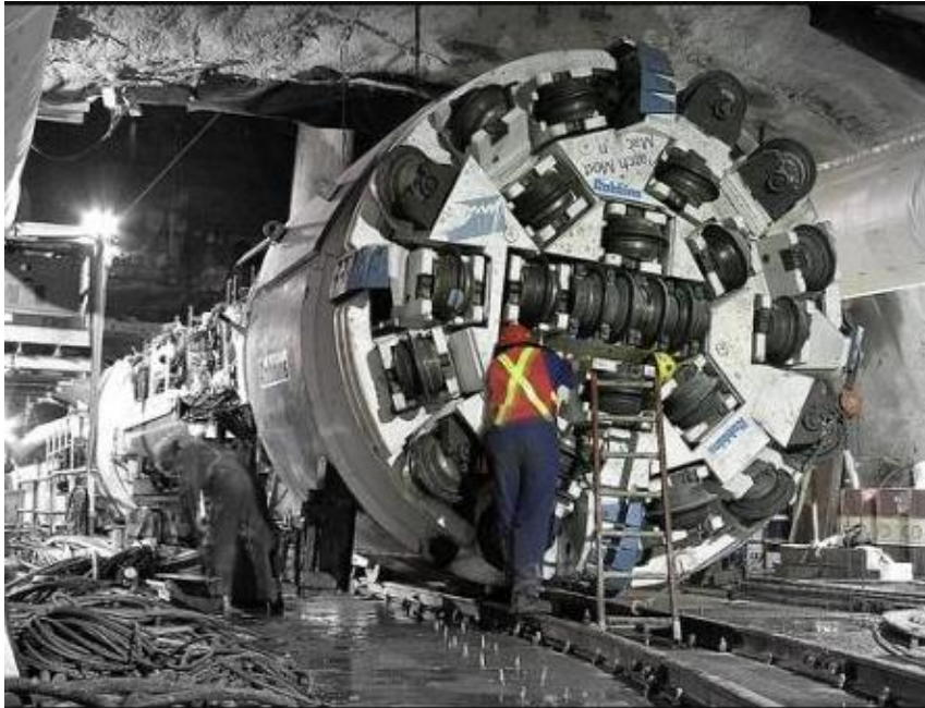
Şekil 2.25 Bakımı yapılmakta olan bir TBM
