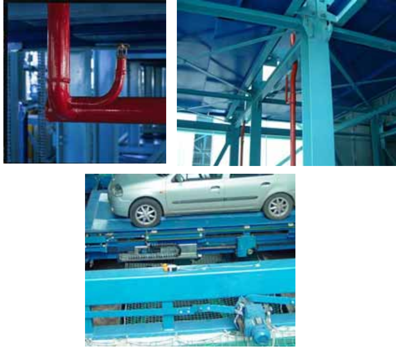
Şekil 3.85 Bina Donanım Görüntüleri (sprinkler, hareket algılayıcılar) [28,29]
