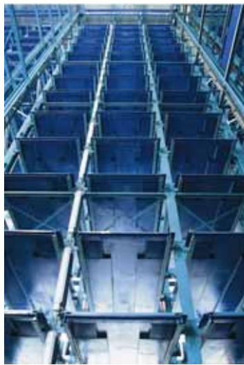
Şekil 3.79 Bina içi-Katlardaki araba rafları
