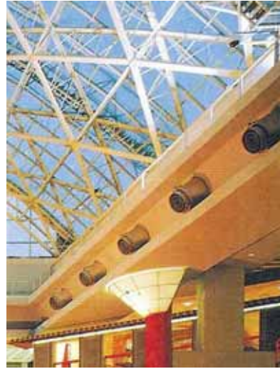
Şekil 3.147 Yapının havalandırma difüzörleri [26,27,30]
