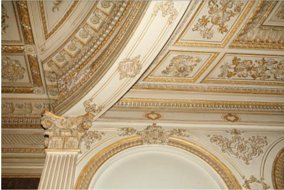
Ş.33. Dolmabahçe Sarayı'nda kullanılan renkler Soğuk beyaz üzerine bezemeler yapılmış tavanda. Geometrik biçimlerin içinde oryantalist yaklaşımlar ile tavan hareketlendirilmiş. Altın varak çerçeveler ile bu hareketlilik desteklenmiş. Ayrıca altın sim ile duvarlarda ve kirişlerde yapılan oryantalist hareketler ile bu hareketlilik desteklenmiş.
