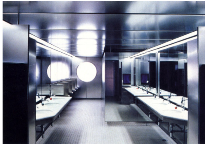
Şekil 3.29. Prefabrik servis modülü iç görünümü [123]
