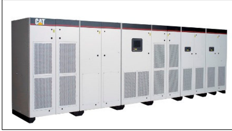
Şekil 2.88. Kesintisiz Güç Kaynağı [99]
