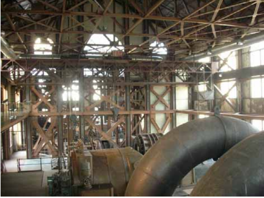
Fotoğraf 2 Silahtaraga Elektrik Santrali iç mekan, 2007.
