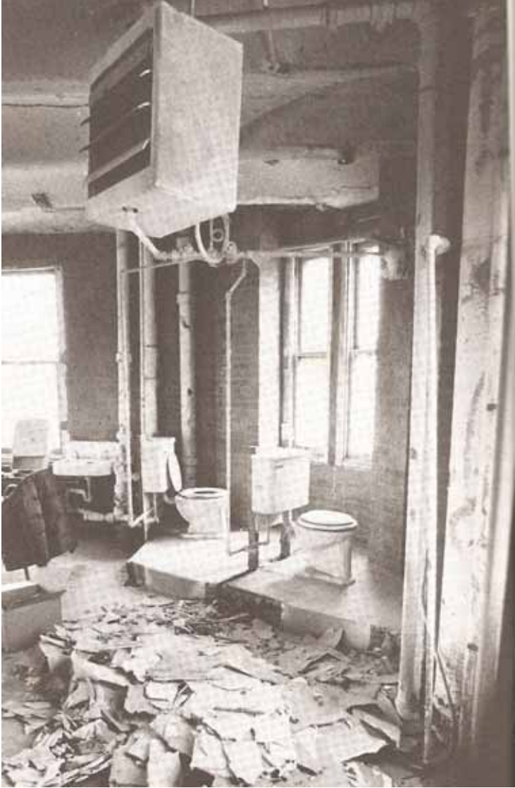
Resim 14 Onarım için hazırlanmakta olan doğal loftta yükseltilmiş döşeme üstünde yer alan iki ayrı tuvalet ve açıkta duran bir adet lavabo görünmektedir. Su ve havalandırma tesisat öğeleri de açıkta durmaktadır.
