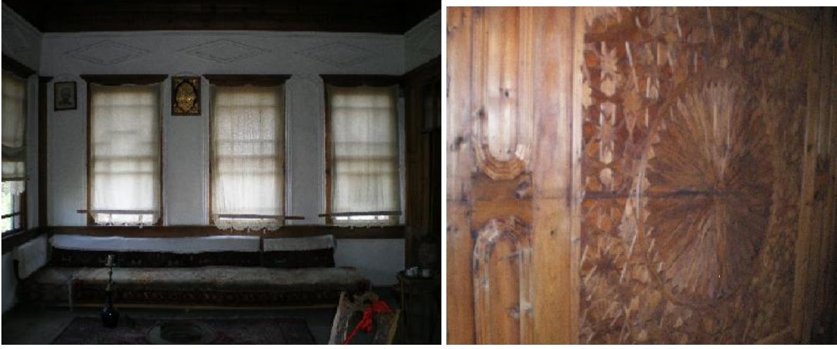
Resim-5.2.41 Mümtazlar Konağı Baş Odası Sedir Tavan İlişkisi. Tekne tavan uygulamasının görülmediği tavanda 4000 parça ahşap kullanılmış olup, oldukça özenli bir işçiliğe rastlanmaktadır. Pencere parapet seviyesinin altında oda duvarlarını boydan boya dolaşan “sandalyalık” adı verilen silme bulunmaktadır. (S.Gülçin Bozkurt,2009)
