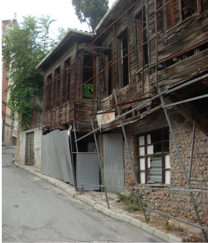
Şekil 83: Muallim Fevzi Sokağı, 1221 Ada/1 Parseldeki binanın yapısal durumunu gösteren fotoğraf (Gündoğan,2010).
