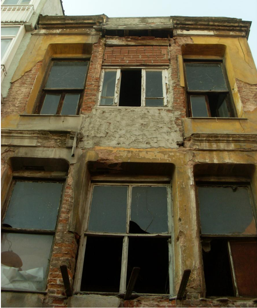
Şekil 75: Pulcu Sokak, 2385 Ada/ 144 Parseldeki yapı ileri derece malzeme ve strüktürel bozulmalar sebebiyle boş durumdadır (Gündoğan, 2010).
