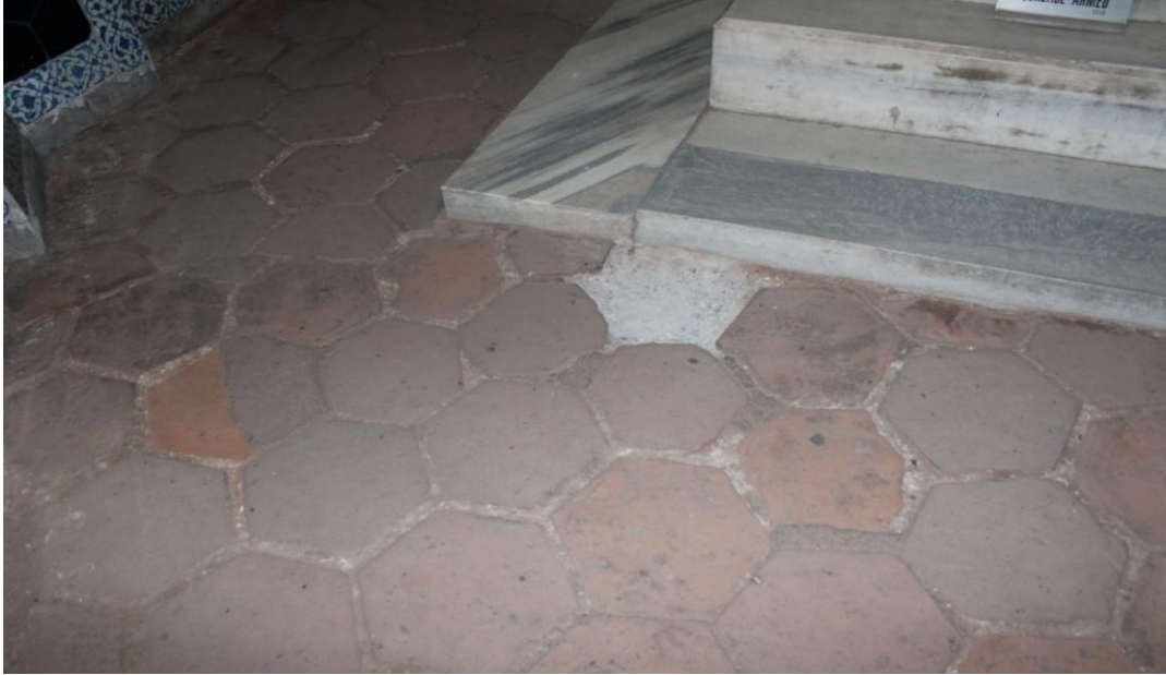
Şekil 3.18 Şehzade Ahmet Türbesi taban tuğlalarındaki kopmalar ve bozulmalar
