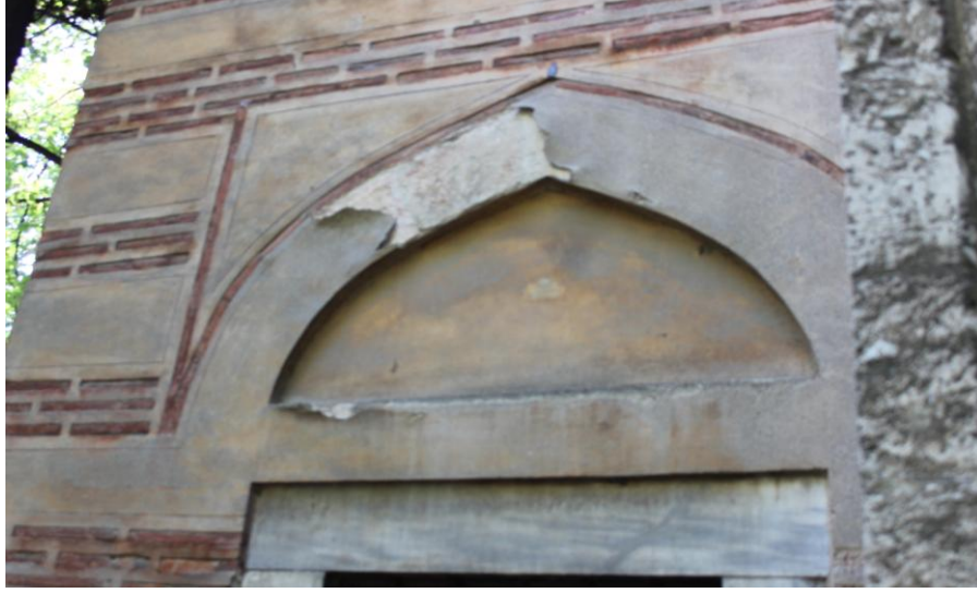
Şekil 3.19 II. Murat Türbesi pencere üstü kemerlerde çimento esaslı derzler ile dış boyanın dökülmesi
