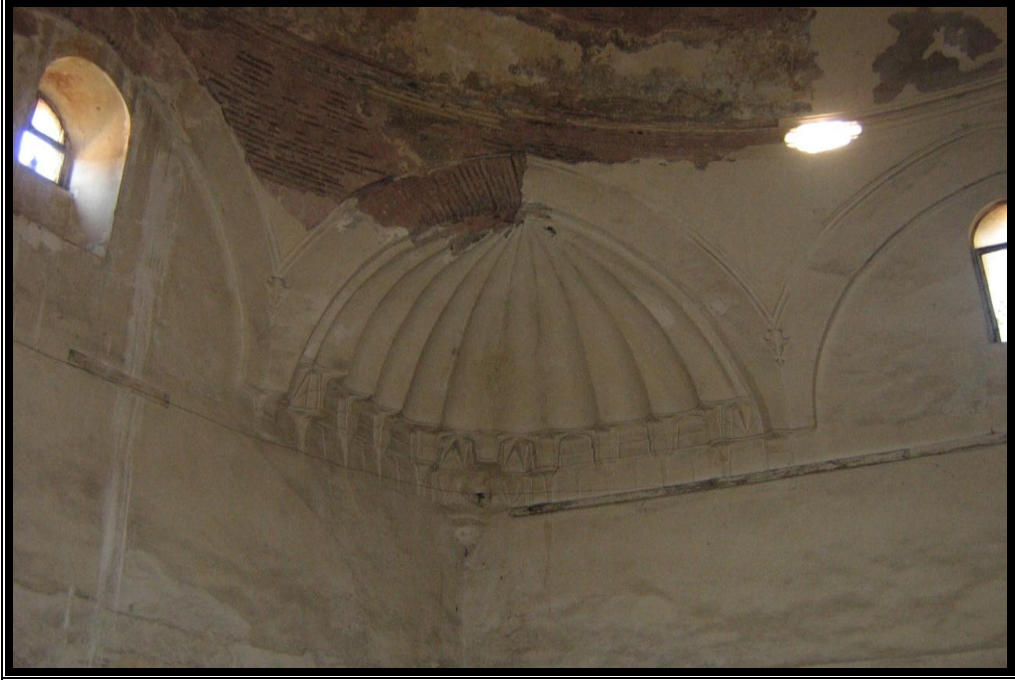
Şekil 3.15 İncirli Hamamı alçı bezemelerinde oluşmuş kabarma ve sıva dökülmeleri
