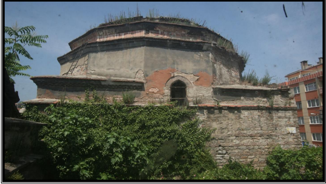
Şekil 3.13 İncirli Hamamı kubbe, kasnak ve beden duvarı yüzeyinde bakımsızlık sonucu oluşmuş bozulmalar
