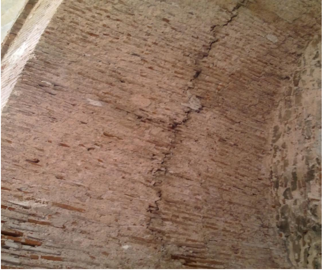
Şekil 3.10 Kayıhan Hamamı kemer iç yüzünde oluşmuş derin çatlaklar
