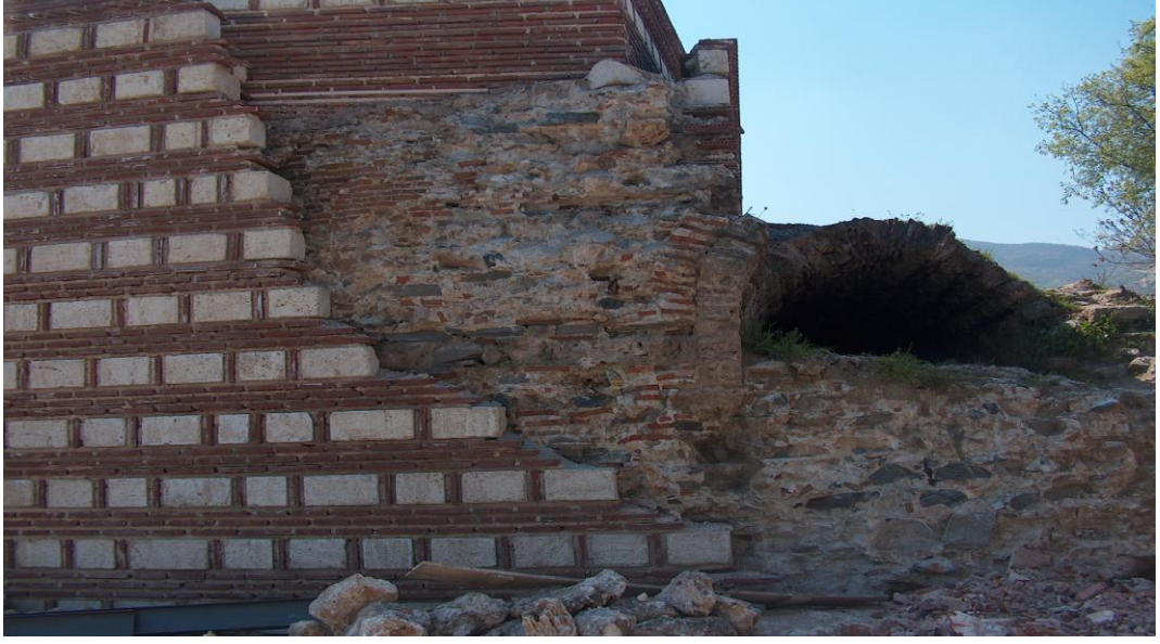
Şekil 3.17 Ördekli Hamamı dış kabuk sistemdeki kopmalar ve yüzey yenilemeleri
