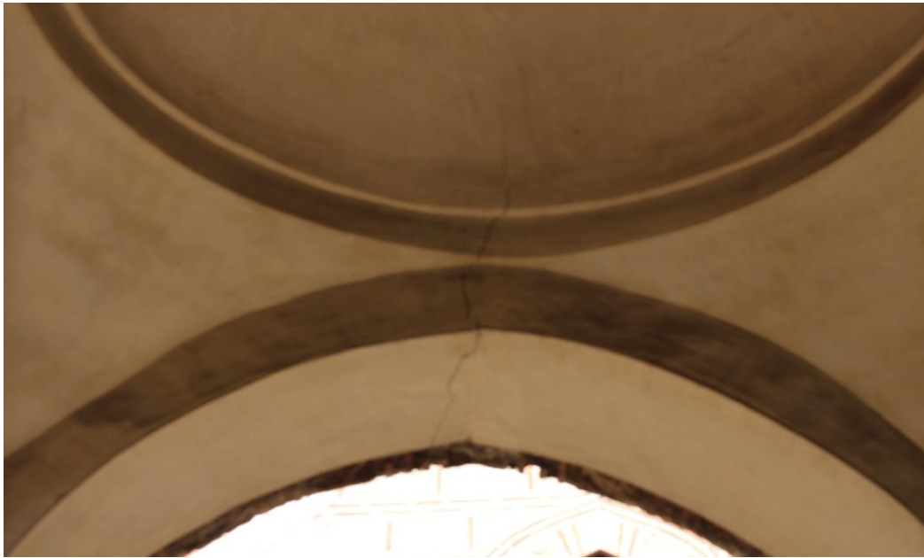
Şekil 3.20 Ebe Kadın Türbesi kubbe ve kemerde meydana gelmiş çatlaklar
