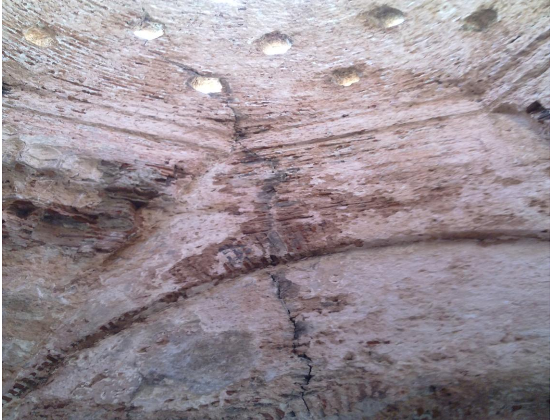
Şekil 3.9 Kayıhan Hamamı kubbe, kasnak ve kemerde oluşan çatlaklar
