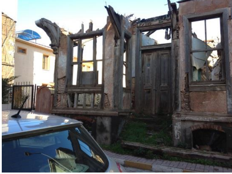
Şekil 4. 35: Fevzi Çakmak Paşa Caddesi'nde bulunan 10 Numaralı tescilli yapının harap durumdaki görünümü (Ezgi Güner,2013)
