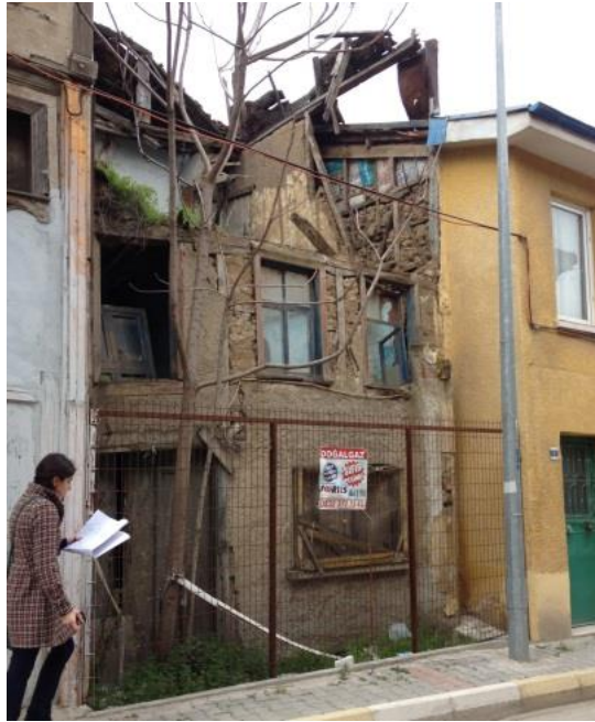
Şekil 4. 32: Hamam Sokak'ta bulunan 18 Numaralı tescile önerilen yapının harap durumdaki görünümü (Ezgi Güner, 2013)
