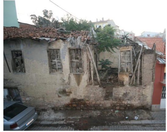
Şekil 5.55; 9 parsel 3 Kapı Numaralı Yapının yıkılmış olan bölümü
