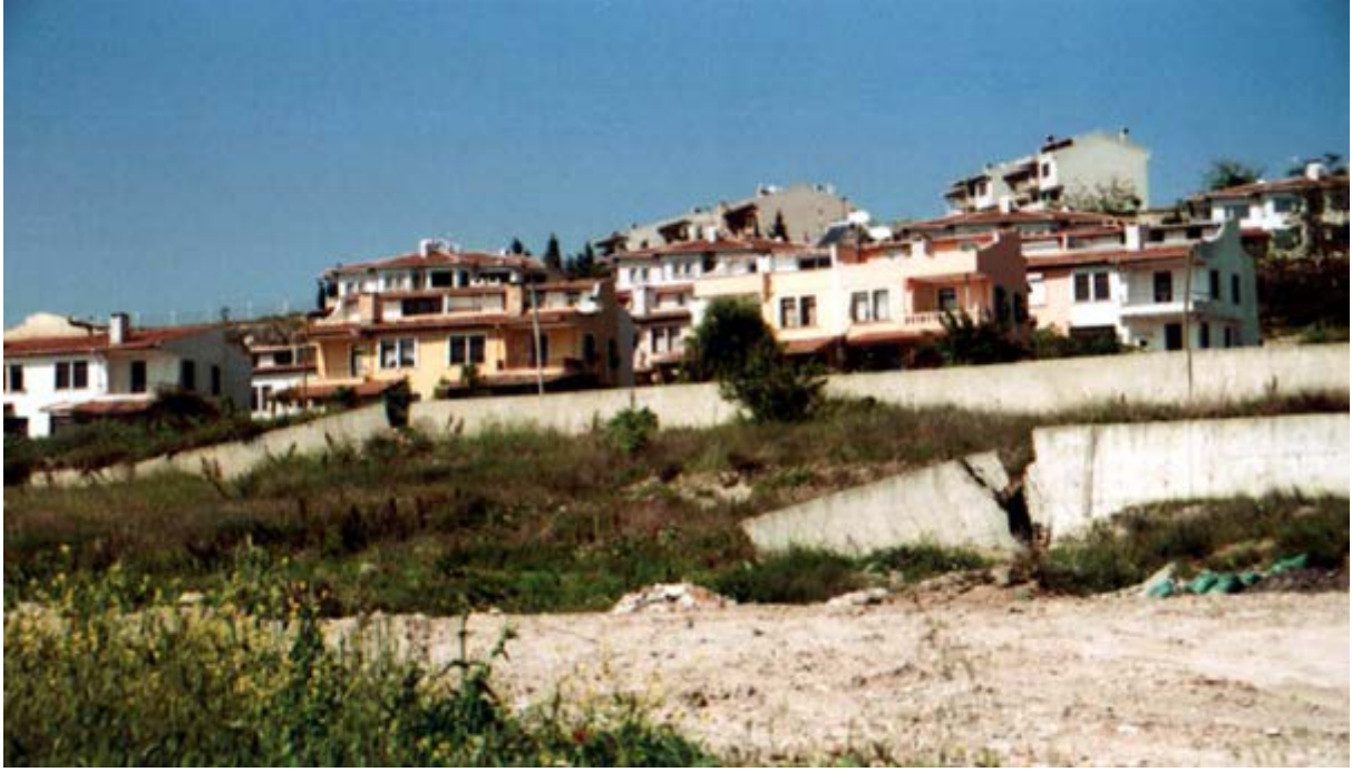
Şekil 2.14: Gürpınar ilçesi batısında heyelandan zarar görmüş istinat duvarları (Demirci, 2009)
