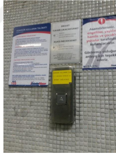
Resim 4.29: Bahçelievler İstasyonu'nda asansörün telefon ile çağırılması
