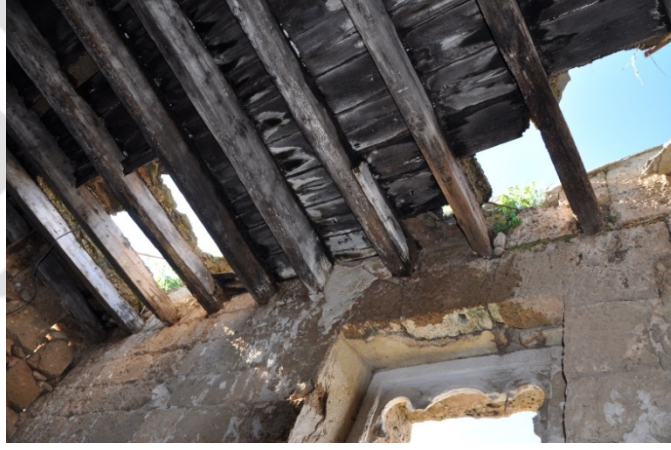
Şekil 3.94: Z-03 mekanındaki strüktürel sorunlar (2015)
