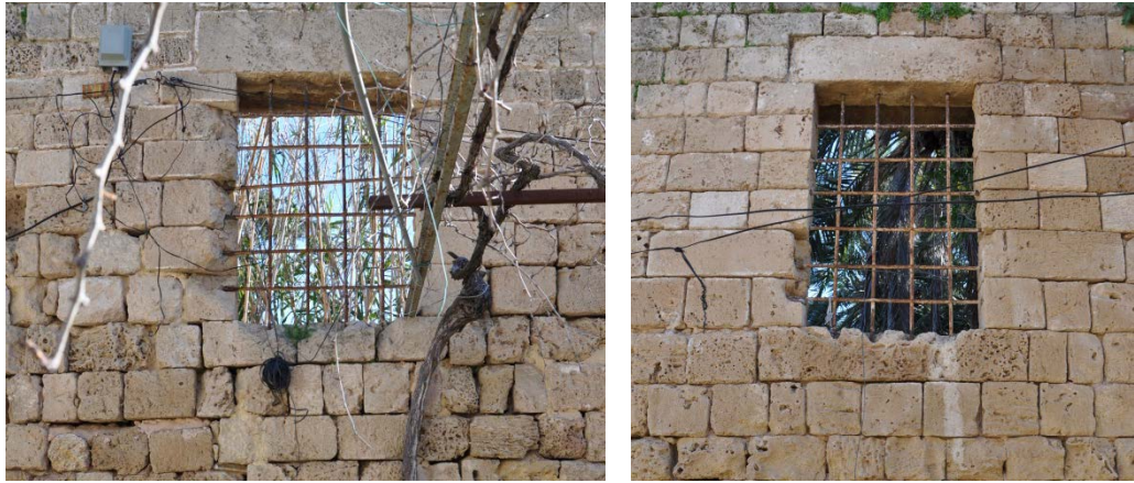
Şekil 3.90: Münür Özbek Sokak'a bakan kuzeybatı avlu cephesinde yer alan demir parmalıkların korozyonu sonucu oluşan parça kopmaları (2015)
