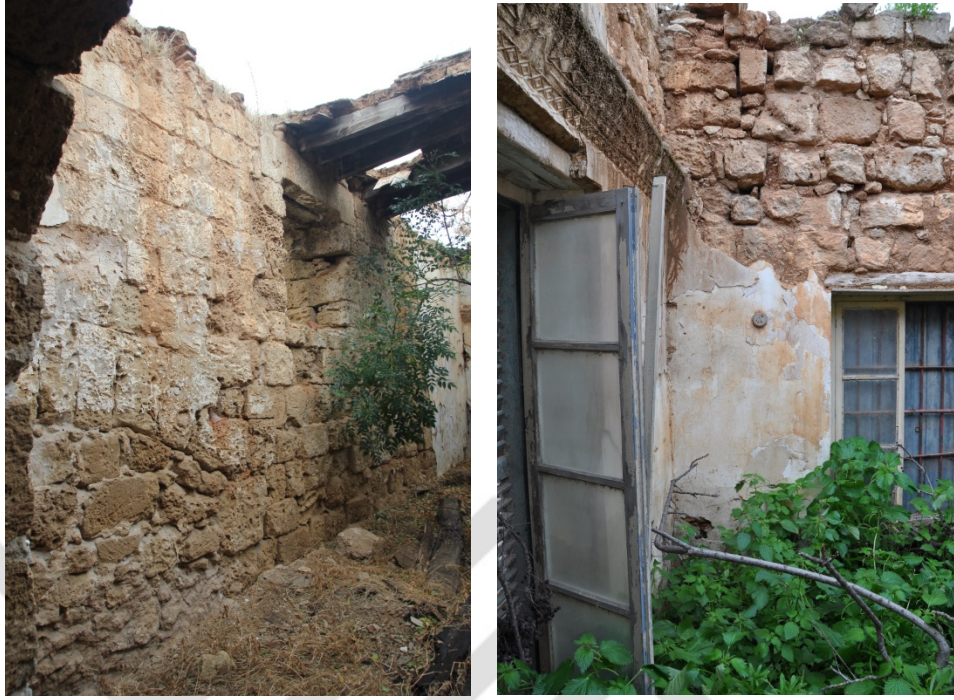
Şekil 3.87: Z-02 mekanı kuzeybatı ve güneydoğu duvarlarında görülen sıva eksilmeleri (2015)
