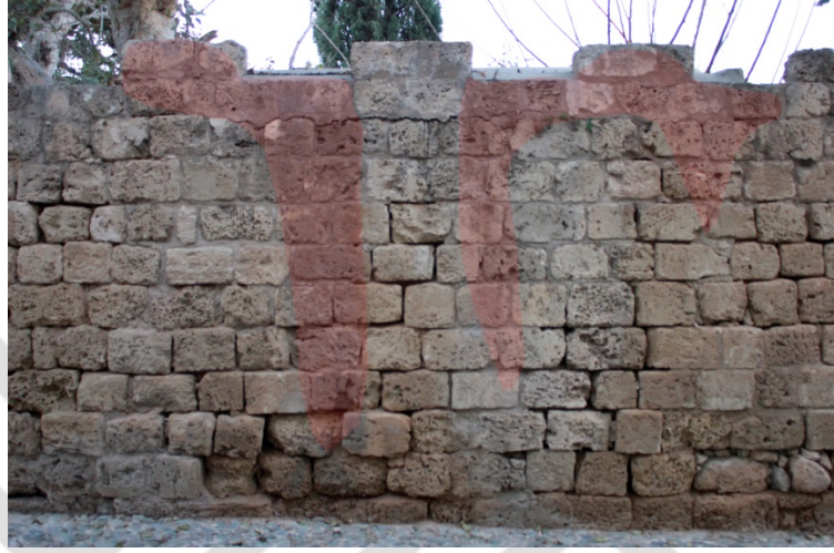
Şekil 3.75: Güneydoğu cephesinde görülen kirlenme örneği (2015)
