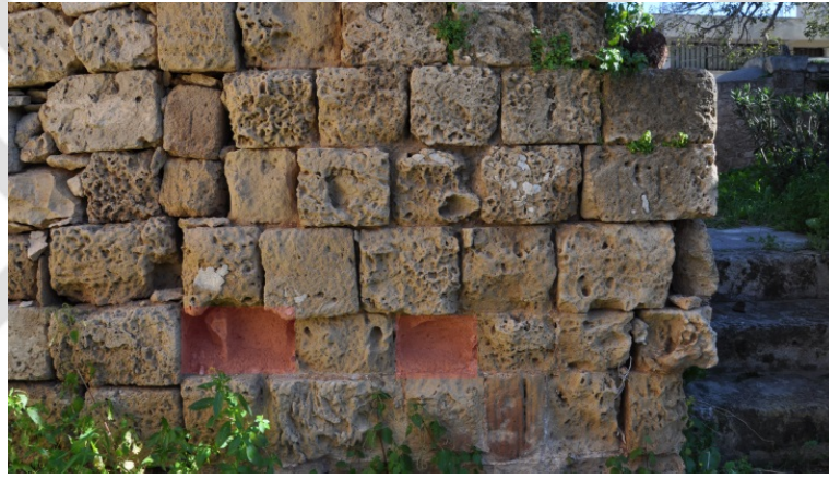
Şekil 3.70: A-01 avlusunun güneydoğu cephesinde görülen yüzey kaybı örneği (2015)
