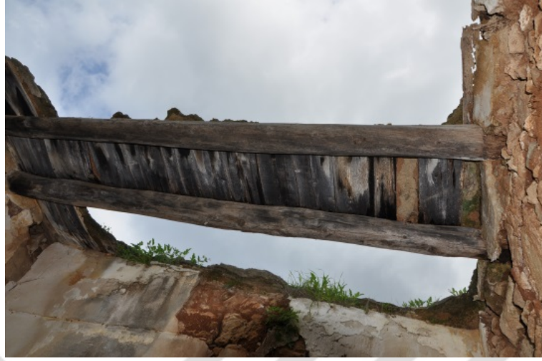
Şekil 3.81: Z-04 mekanının ahşap tavan kaplaması ile taşıyıcılarında görülen bozulmalar (2015)
