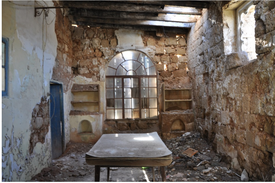
Şekil 3.86: Z-03 mekanı güneybatı, kuzeybatı ve güneydoğu duvarlarında görülen sıva eksilmeleri ve dökülmeleri (2015)
