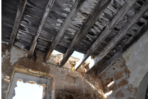
Şekil 3.95: Z-03 mekanındaki strüktürel sorunlar (2015)
