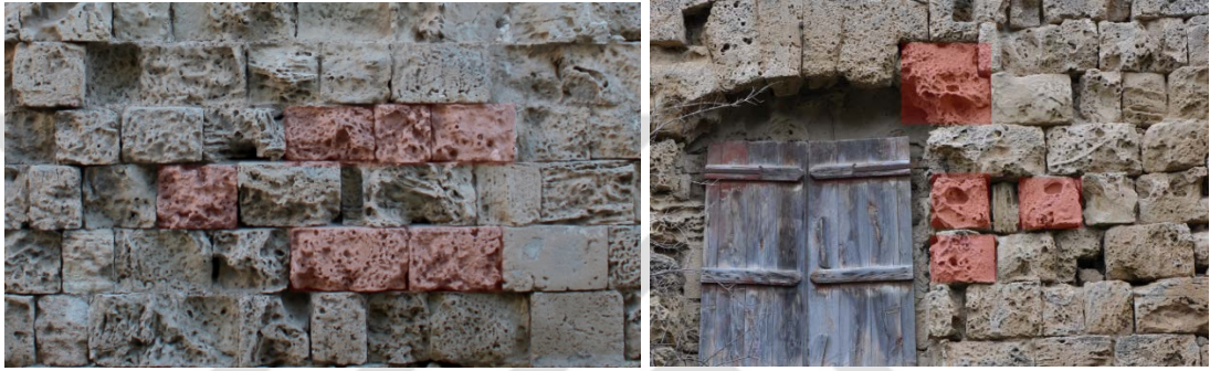
Şekil 3.68: Kuzeydoğu cephesi ve A-02 avlusunun kuzeydoğu duvarı oyuklanma örneği (2015)
