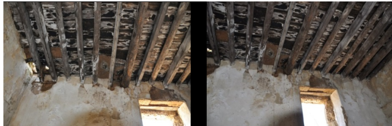
Şekil 3.78: Z-01 mekanının ahşap tavan kaplaması ile taşıyıcılarında görülen bozulmalar (2015)
