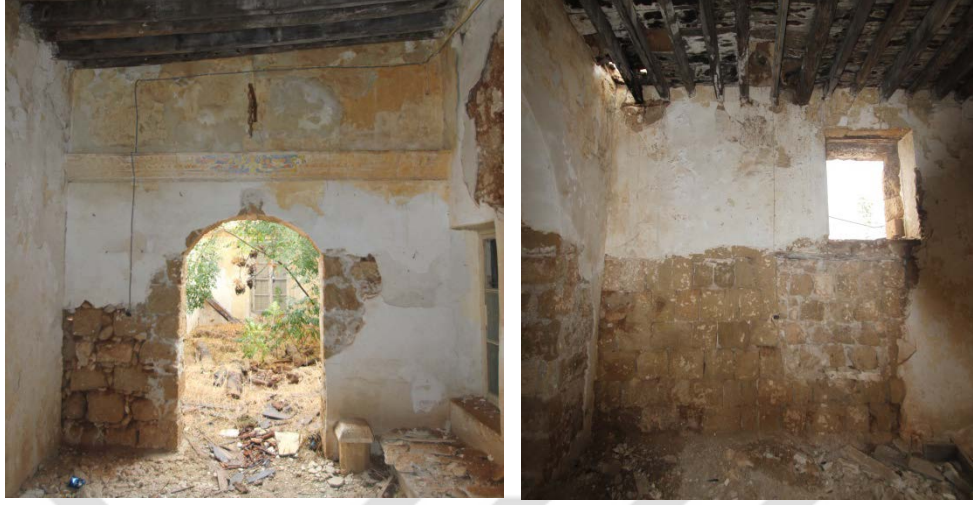
Şekil 3.85: Z-01 mekanı kuzeydoğu ve kuzeybatı duvarlarında görülen sıva dökülmeleri
