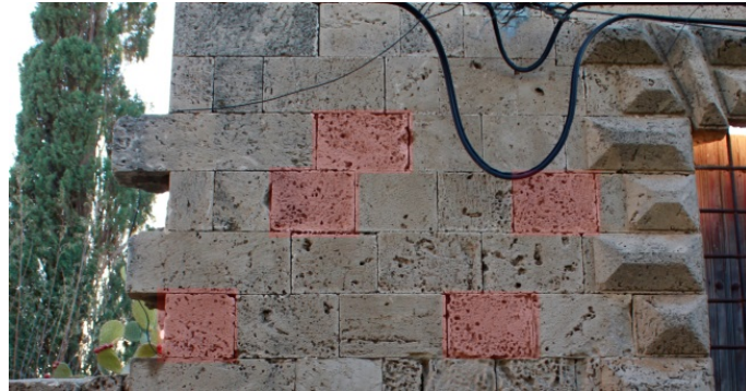
Şekil 3.67: Kuzeydoğu avlu duvarındaki deliklenme örneği (2015)
