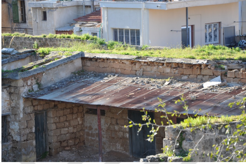
Şekil 3.91: Çatıdaki bitki oluşumları (2015)
