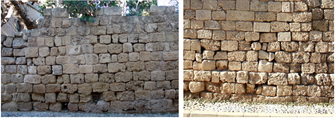
Şekil 3.83: Bedesten Sokak üzerindeki güneydoğu cephesi ve Naim Efendi Sokak üzerindeki Kuzeydoğu cephesinde görülen derz eksilmeleri ve boşalmaları (2015)
