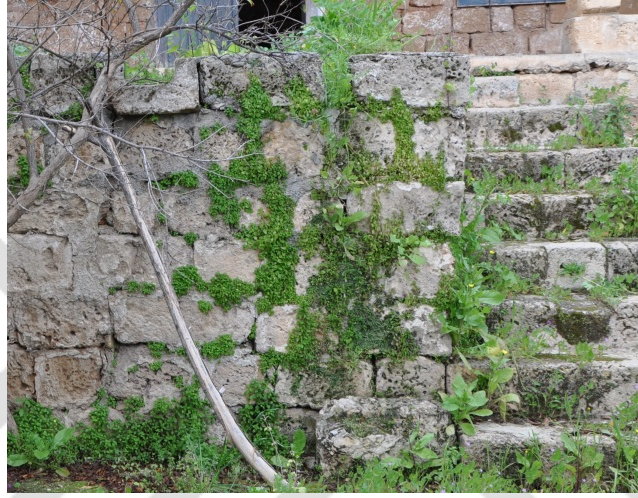
Şekil 3.71: A-01 avlusunun kuzeybatı cephe duvarlarında görülen bitkilenme örneği (2015)
