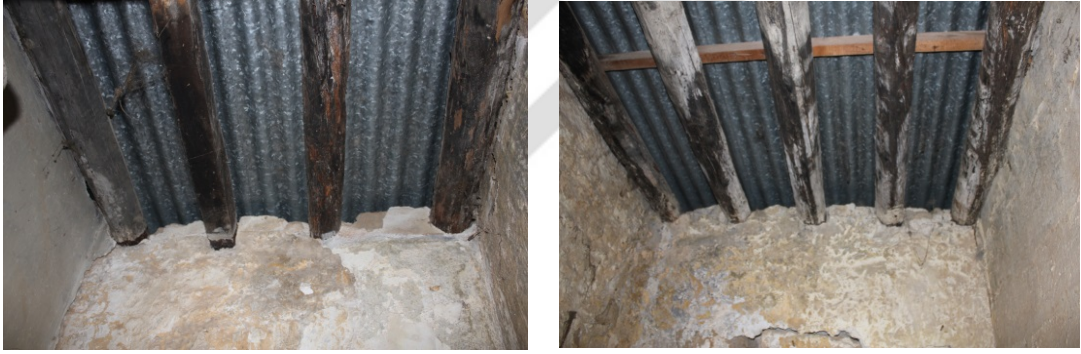
Şekil 3.82: Z-05 mekanının ahşap taşıyıcılarında görülen bozulmalar (2015)
