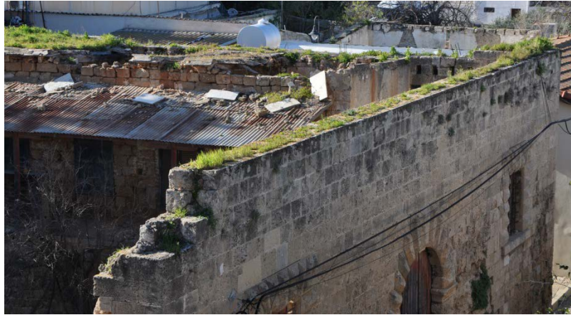
Şekil 3.72: Kuzeydoğu cephe duvarları ile çatı üzerinde görülen bitkilenme örneği (2015)
