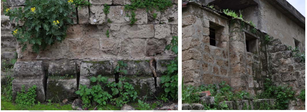
Şekil 3.73: Kemer taşları üzerinde ve kuzeybatı tuvalet cephesinde görülen yosunlanma örneği (2015)
