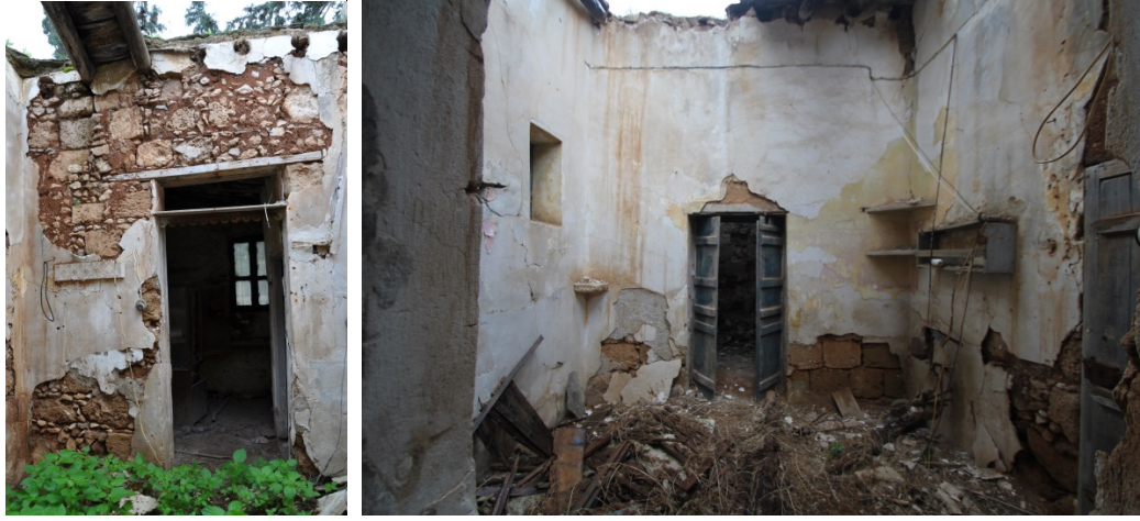
Şekil 3.89: Z-04 mekanı güneydoğu ve kuzeybatı duvarlarında görülen sıva eksilmeleri ve dökülmeleri (2015)
