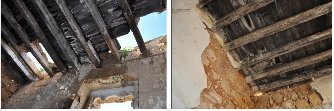
Şekil 3.79: Z-03 mekanının ahşap tavan kaplaması ile taşıyıcılarında görülen bozulmalar (2015)
