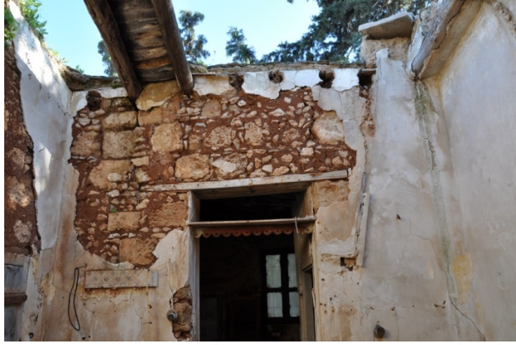
Şekil 3.96: Z-04 mekanındaki strüktürel sorunlar (2015)
