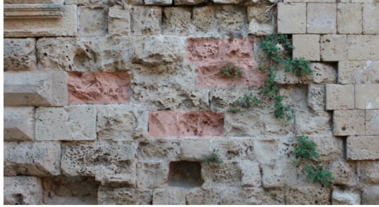
Şekil 3.69: Kuzeydoğu avlu duvarındaki yüzey kaybı örneği (2015)
