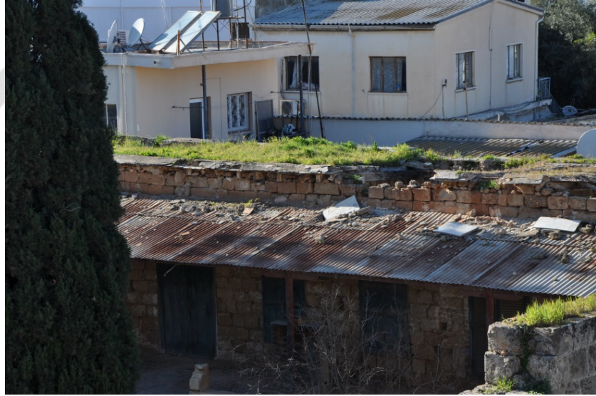
Şekil 3.92: Çatıdaki bitki oluşumları (2015)
