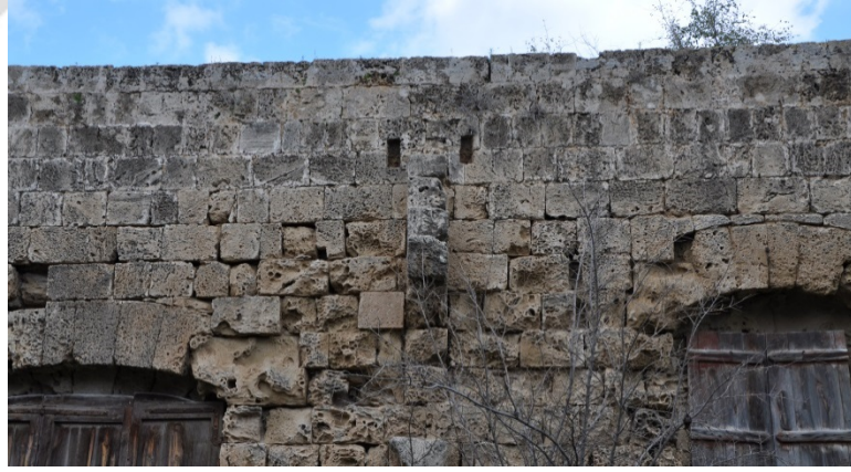
Şekil 3.76: A-02 avlusunun kuzeydoğu cephesinde görülen kirlenme örneği (2015)
