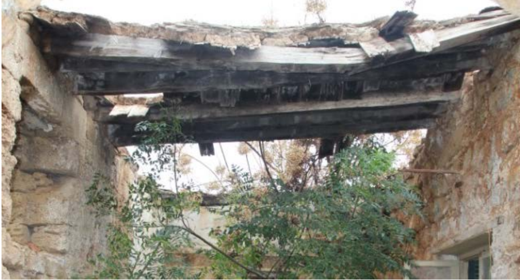
Şekil 3.80: Z-02 mekanının ahşap tavan kaplaması ile taşıyıcılarında görülen bozulmalar (2015)
