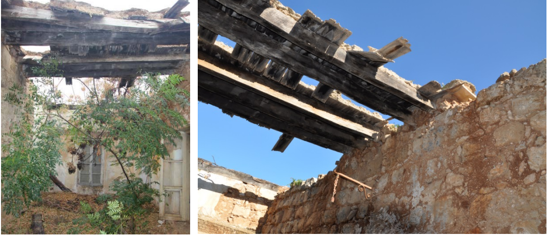
Şekil 3.93: Z-02 mekanındaki strüktürel sorunlar (2015)
