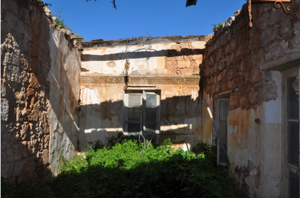
Şekil 3.88: Z-02 mekanı kuzeydoğu duvarında görülen sıva bozulmaları (2015)
