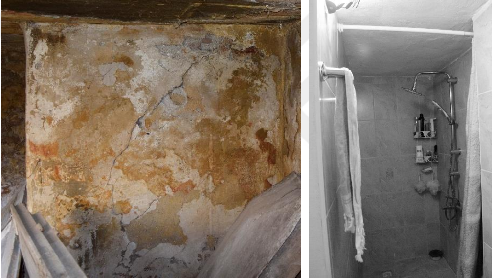
Şekil 6.1: B02 mekânı kuzey duvarının arkası 22 parseldeki yapının banyosu olarak kullanılmaktadır (Konuk, Kuşadası, 2016)
