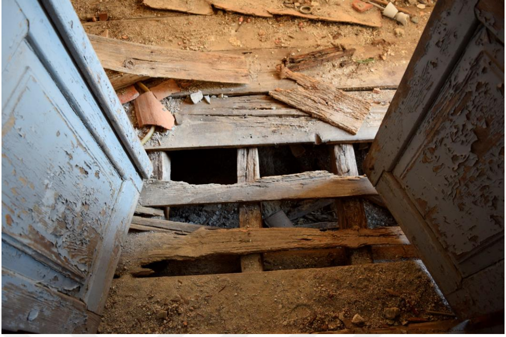
Şekil 4.119: Z03 mekânının döşeme altında bulunan boşluk (Konuk, Kuşadası, 2016).
