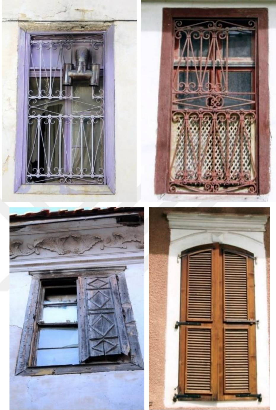
Şekil 3.6: Soldan sağa demir parmaklı, ahşap kafesli, ahşap kapaklı pencere örnekleri (Kuşadası Kültür Derneği Arşivi)
