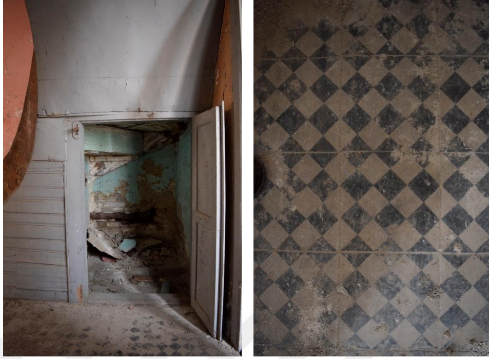
Şekil 4.24: Soldan sağa, Z01 mekânının merdiven altında bulunan dolap ve zemin kaplaması (Konuk, Kuşadası, 2016).
