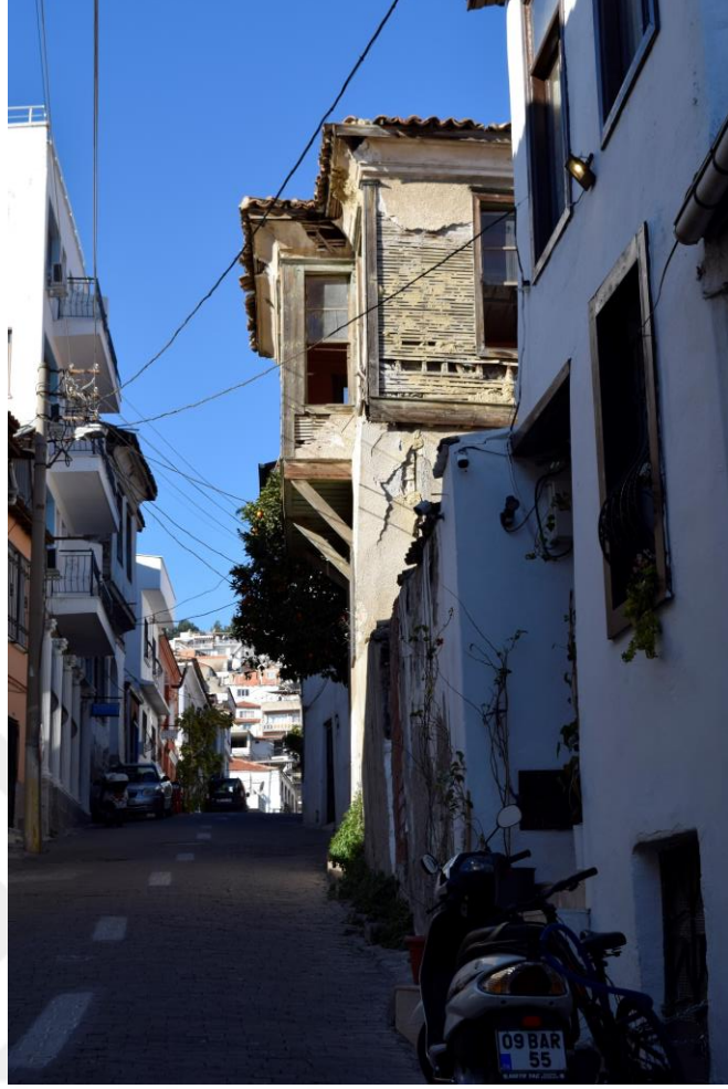
Şekil 5.1: Güney cephe duvarında oluşan sehim (Konuk, Kuşadası, 2016).
