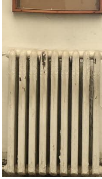
Şekil 5.13. Dökme Demir Kalorifer Petek, 2017
