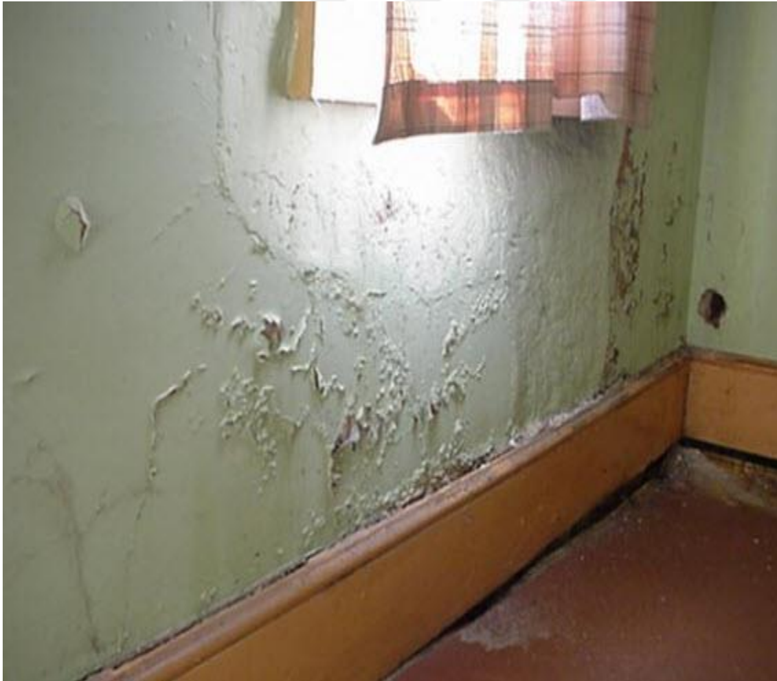
Resim 4. 7: Temizlenmeye İhtiyacı Olan Duvar
