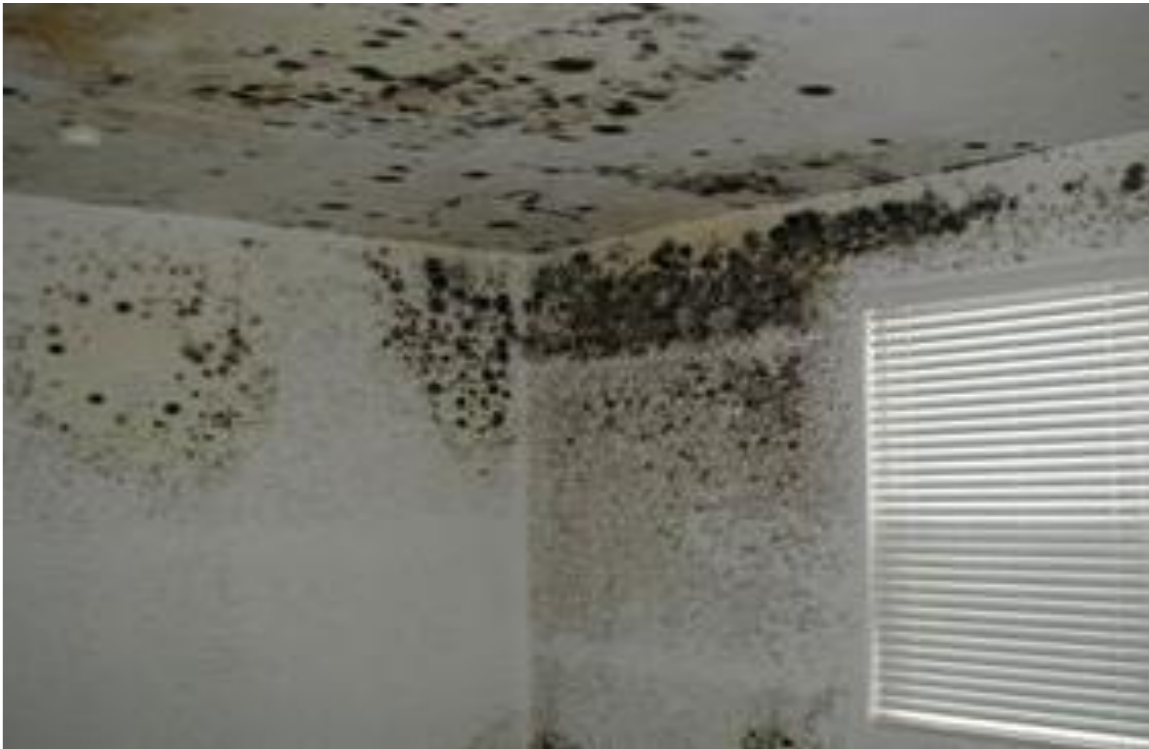
Resim 4. 6: Duvarlarda ve Tavanda Oluşan Küfler
