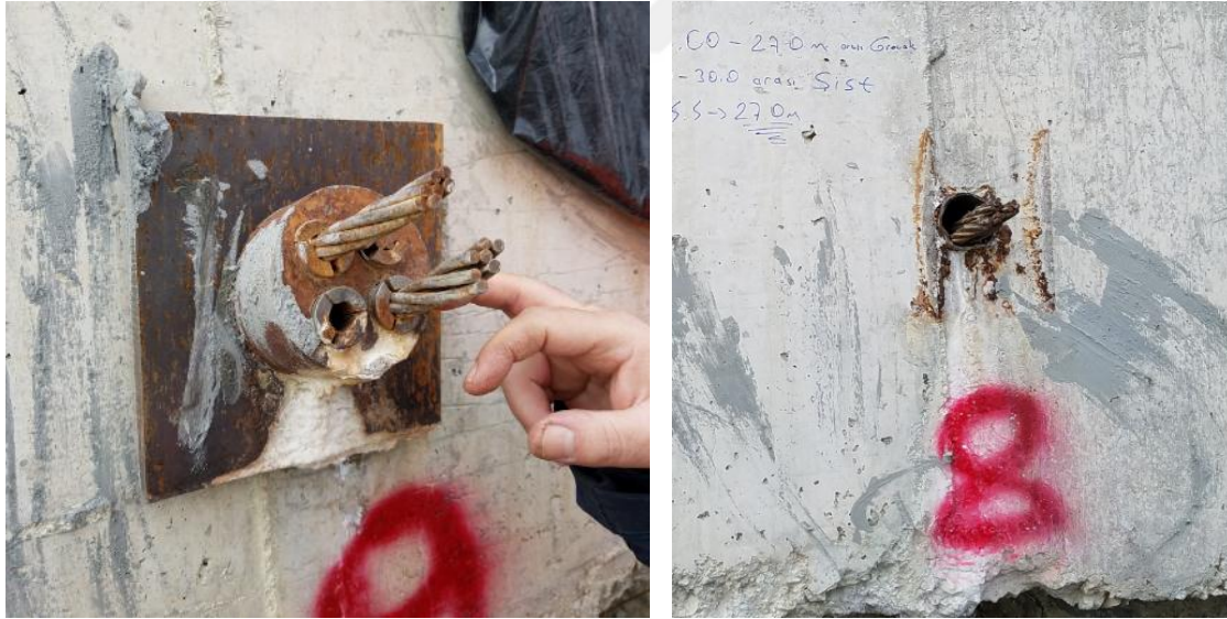
Resim 4.7. Ankraj kafalarında halat sıyrılması
