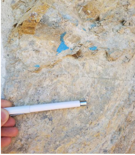
Resim 4.5. Fore kazıdaki kılcal çatlak
