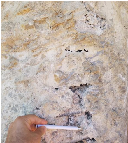
Resim 4.6. Kazıklarda beton dökümü ve vibrasyon hataları
