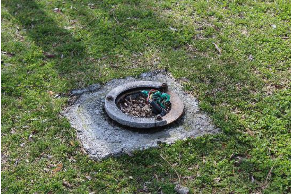
Fotoğraf 4.17. Elektrik Açıklıkları
