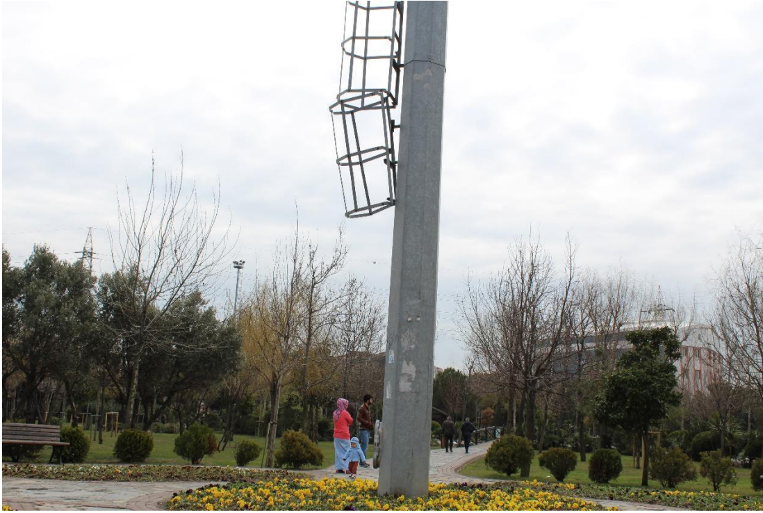
Fotoğraf 4.12. Elektrik Direkleri
