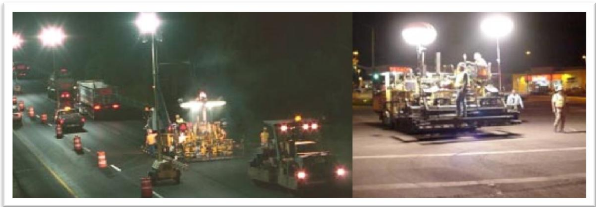
Resim 4.1. Gece çalışmalarında sahanın aydınlatılması örnekleri 10
