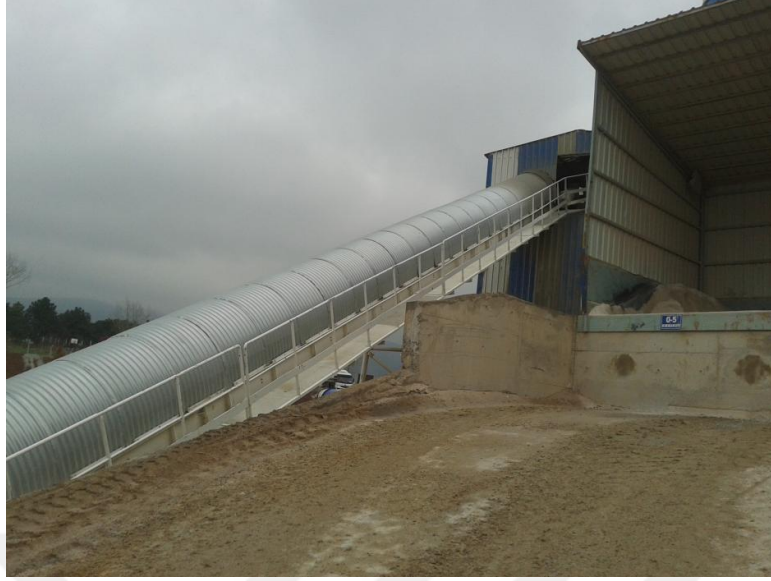
Şekil 22: Taşıma Bandında Koruyucu Panel Önlemi
